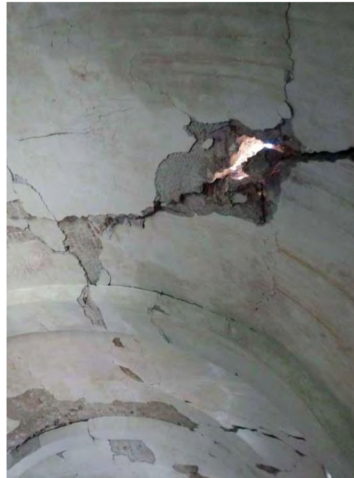
Fracturas y colapsos parciales en bóveda. Archivo de la MAECPE, 2019
