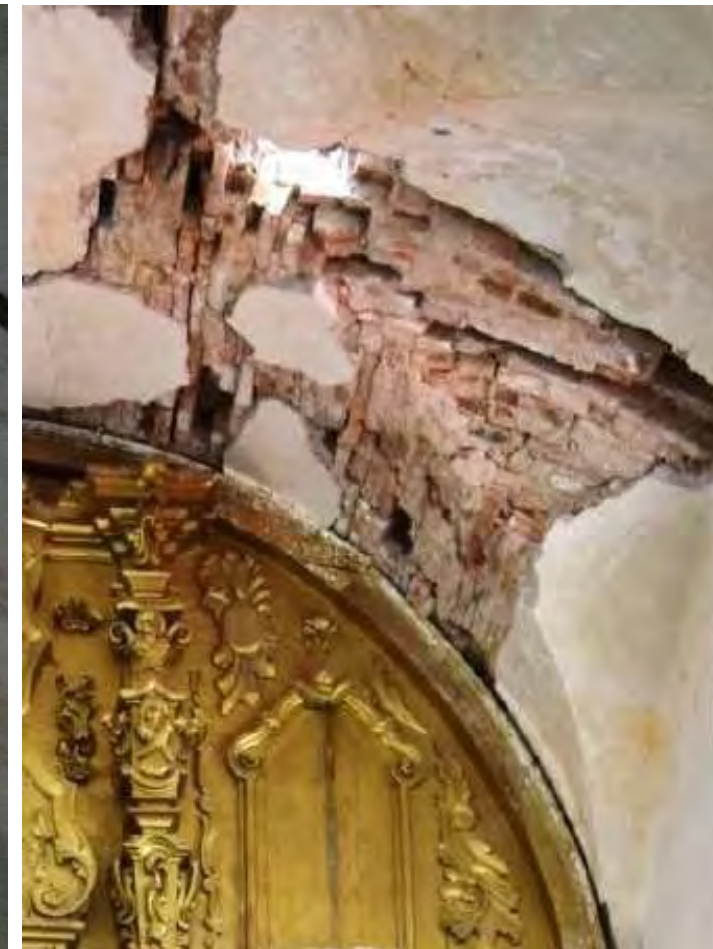
Fractura y desprendimiento de mampuestos en bóveda de ábside Templo de San Felipe Apóstol, Xochiltepec, Puebla. Archivo de la MACPE, 2019
