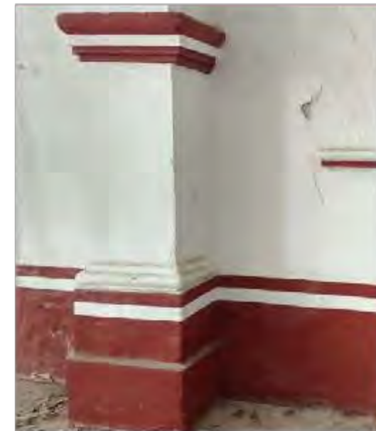
Imagen 2: Pilastra Sur de Sotocoro Vista Frontal
