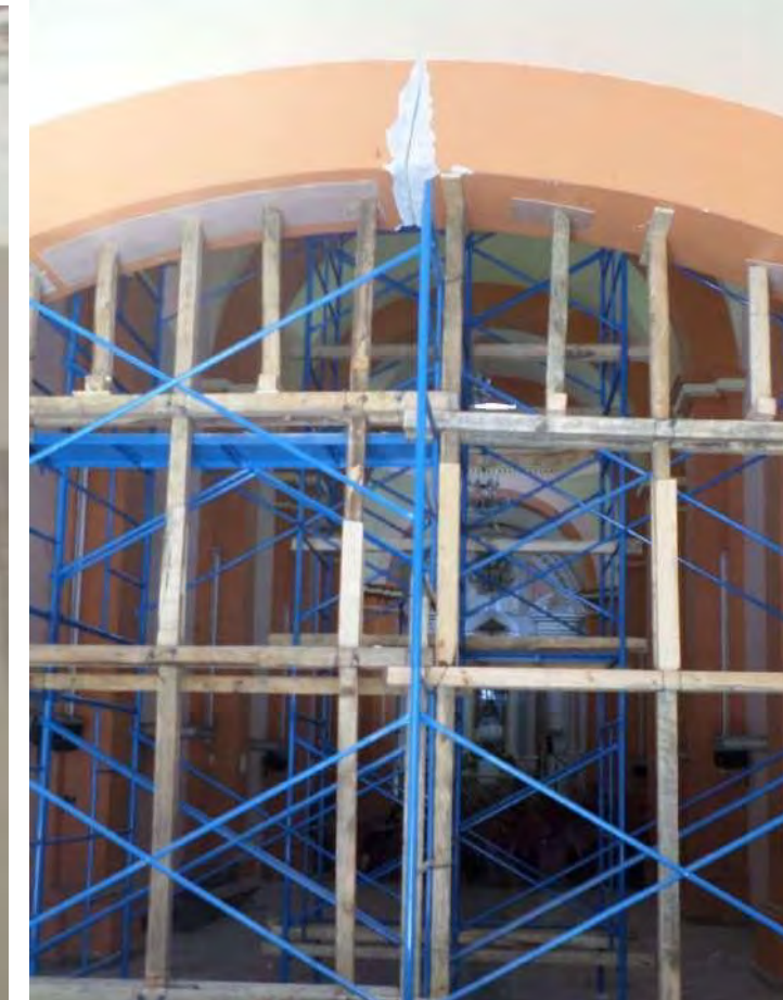
Agrietamiento en clave de arco en portada de acceso. Templo de Santa María Magdalena, Atoyatempán, Puebla. Sánchez Paulino, 2018.
