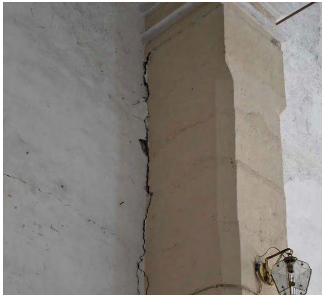
Una afectación muy común de las pilastras es la separación del elemento del muro adyacente Archivo MAECPE, 2018
