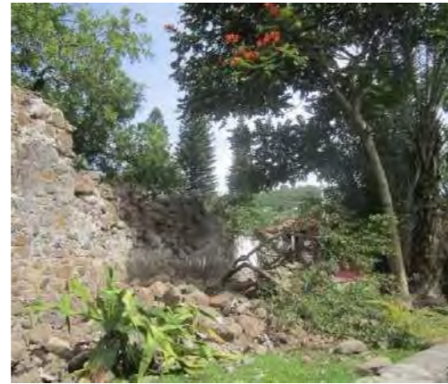
Imagen 18. Daños presentes en barda atrial del templo de San Agustín Obispo
