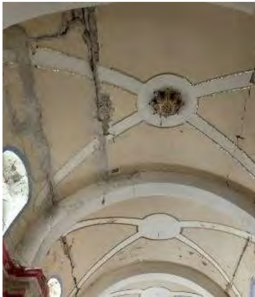
Grietas en bóveda de nave en el sentido longitudinal Templo de San Pedro Yeloixtlahuacan, Puebla. Sánchez Paulino, 2019
