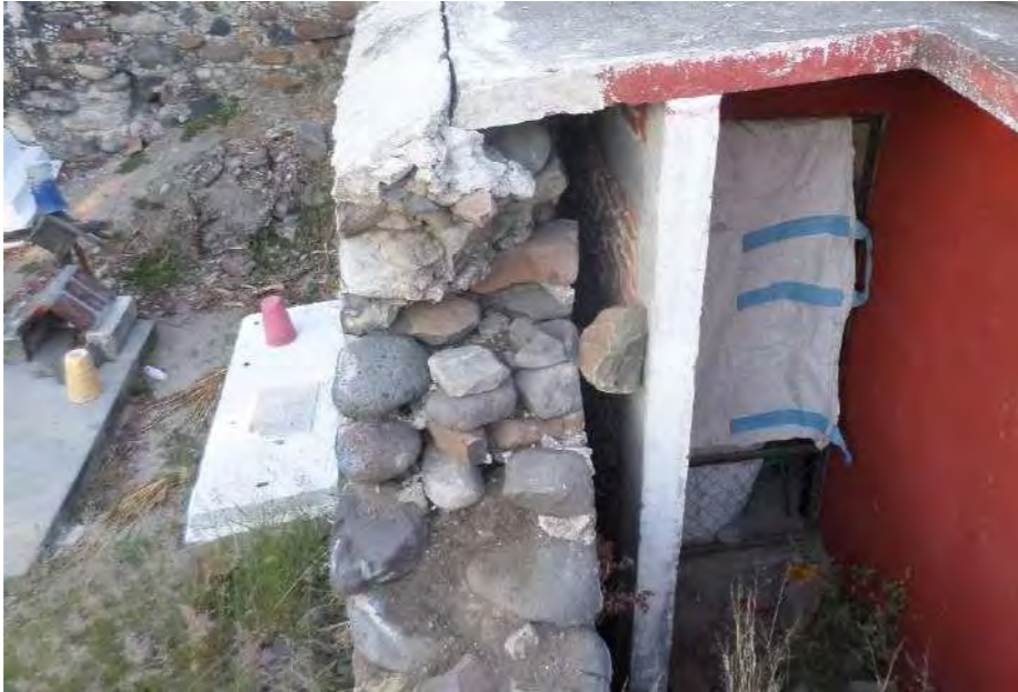
Imagen. 4. Muro de piedra de canto rodado colapsado, se aprecia el empleo de tierra y lodo como material de cohesión para el mampuesto. Fuente: Sánchez Paulino, 2018.
