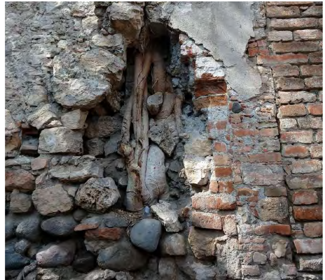
Imagen. 3. La falta de mantenimiento puede propiciar que agentes invasivos proliferen al grado de afectar de manera grave la construcción, en la imagen las raíces de un árbol que crece desde el interior del muro provoca roturas y desprendimiento en el mismo. Fuente: Sánchez Paulino, 2018.
