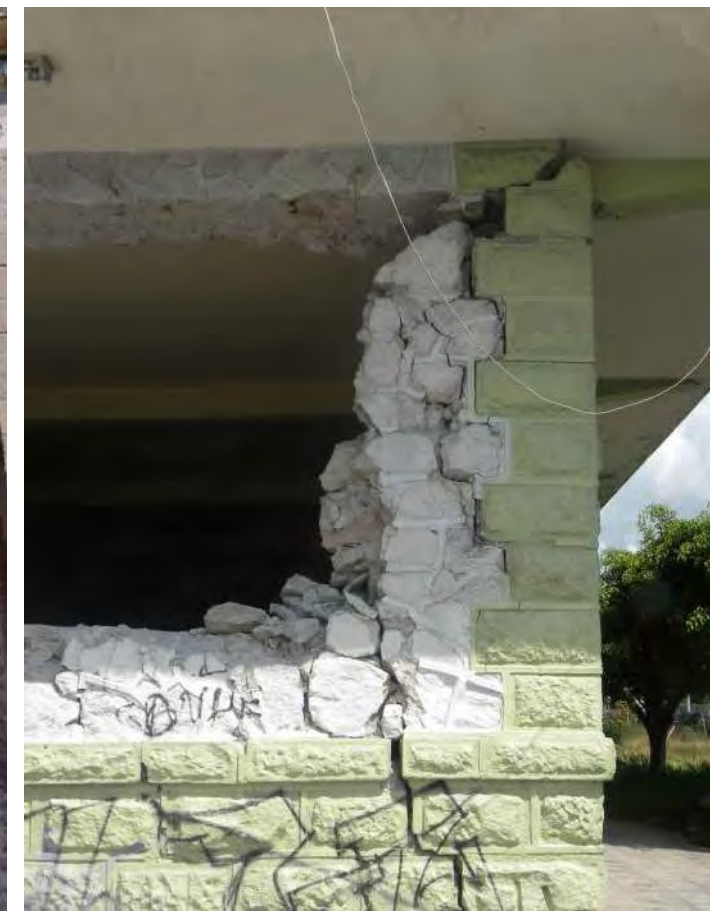
Colapso parcial y fracturas en muro de piedra Ex estación de ferrocarril de Izúcar de Matamoros Sánchez Paulino, 2018
