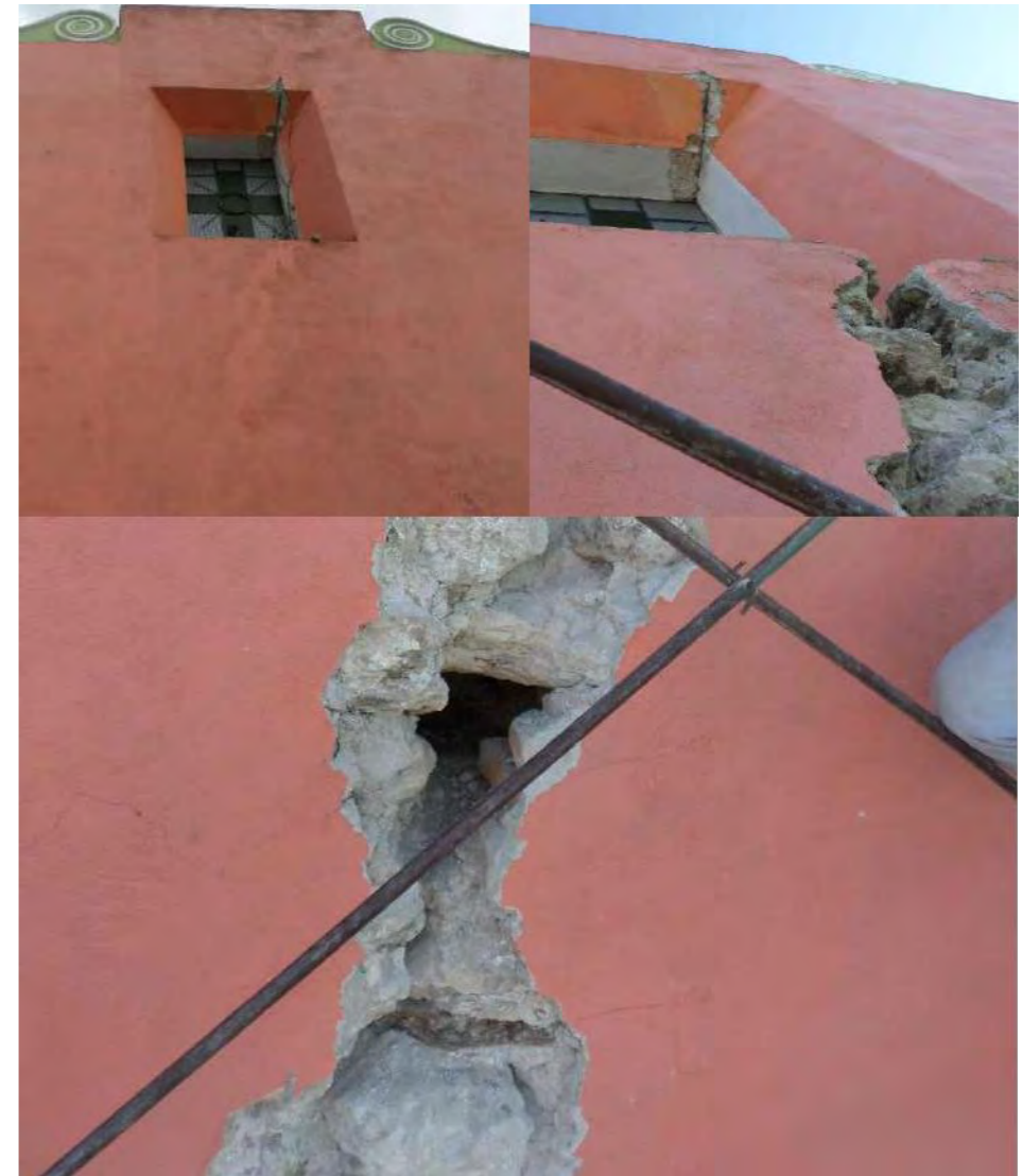
Imagen. 16. Primera imagen superior izquierda, muro reparado con resurgimiento de la grieta tras un movimiento sísmico, se observa el área donde hubo intervención anterior por el cambio de tonalidad en el muro. Foto superior derecha, una vez que se liberó la fisura mostrada tras el evento sísmico se observa la magnitud del daño, la grieta profunda y amplia, tal cual como si no hubiera sido resanada.
