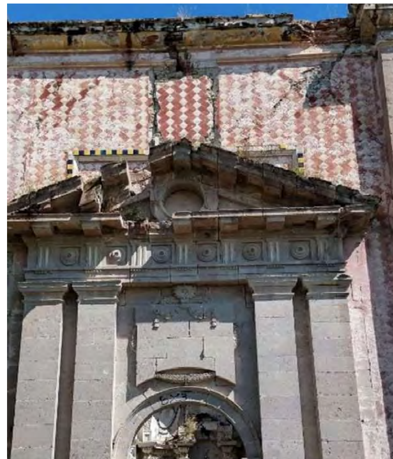
Muro con grietas multidireccionales desde portada principal hasta pretil Templo de la Ex Hacienda de San Juan Raboso, Puebla, fachada principal. Sánchez Paulino, 2018
