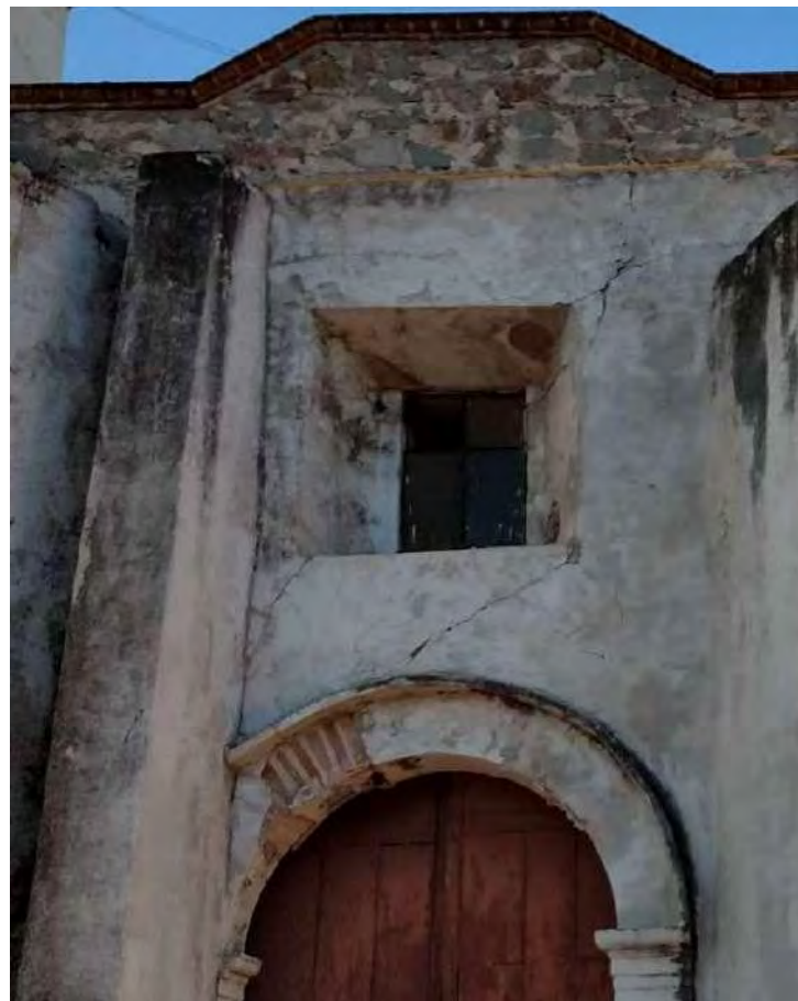
Muro con grietas multidireccionales en ascendencia de vano de acceso secundario hasta pretil. Templo de San Pedro Yeloixtlahuacan, Puebla, fachada Sur Sánchez Paulino, 2019.
