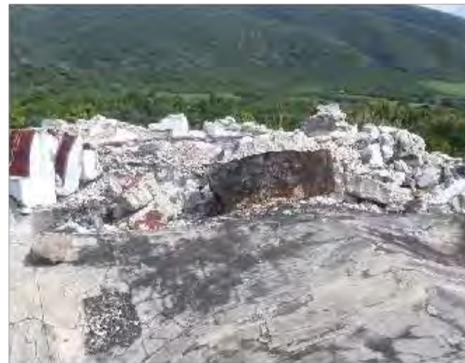
Imagen 3: Vista por el exterior, se aprecia el escombros resultante del colapso de cúpula
