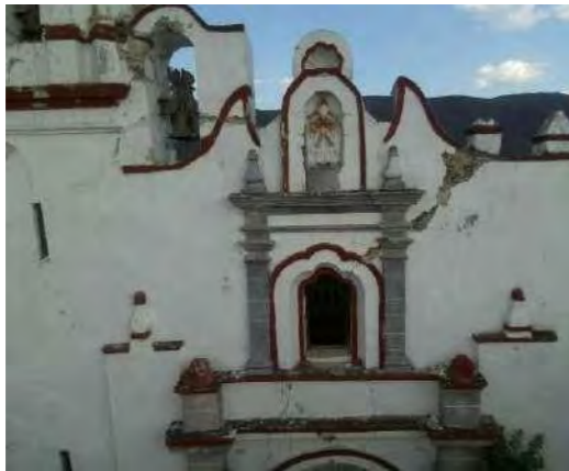
Imagen 17. Vista parcial de la fachada principal del templo de San Agustín Obispo
