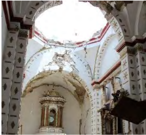
Imagen 15. Vista general de los daños en el interior de la nave del templo de San Agustín Obispo
