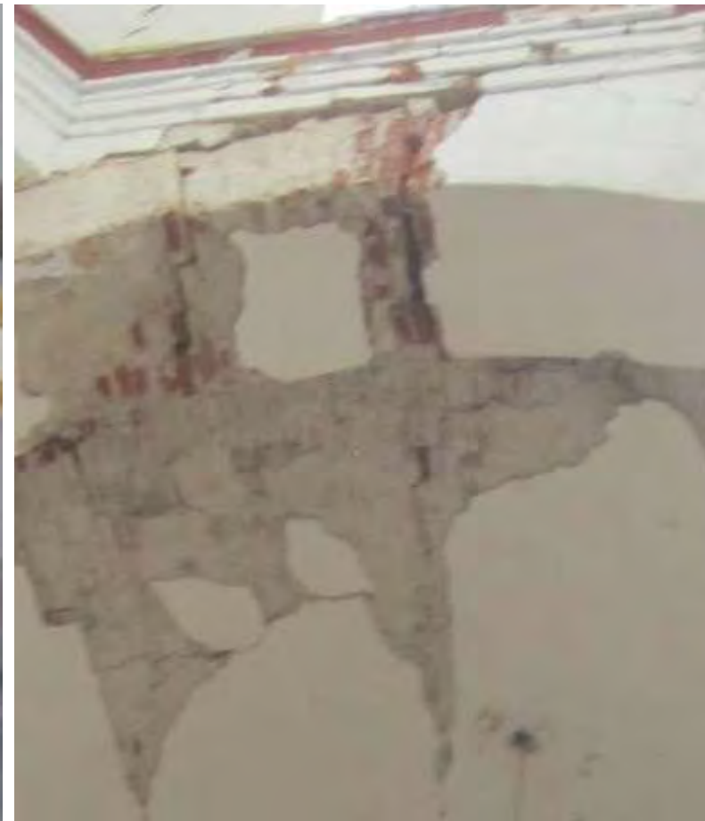
Grietas en arco de mampostería de ladrillo, en sección media Templo la Virgen de Ocotlán, Tepexco, Puebla, interior de nave. Sánchez Paulino, 2018.
