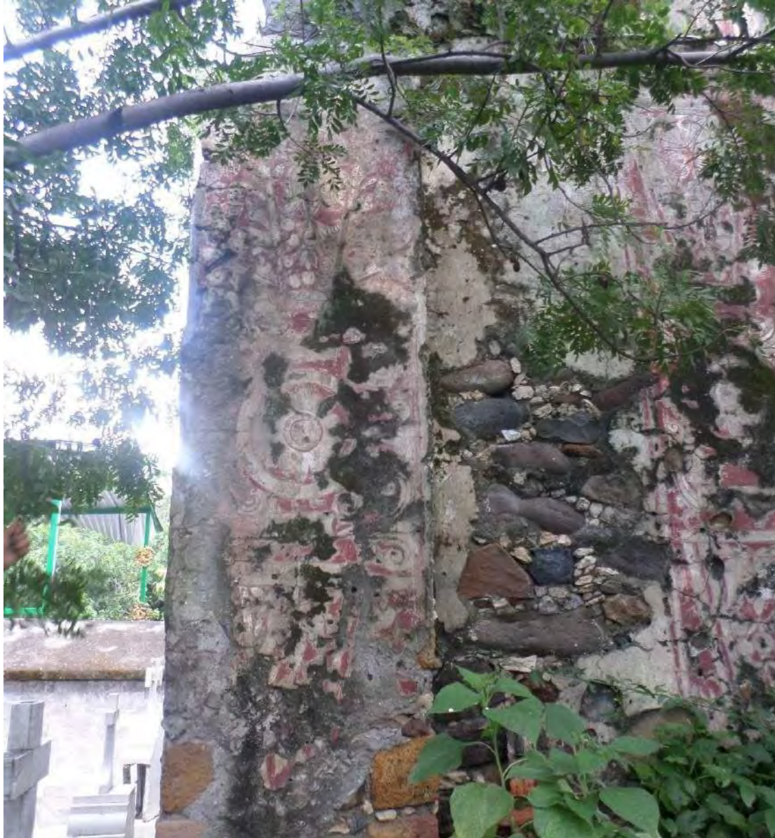
Imagen. 27. Restos de pintura primigenia en muro exterior sur del baptisterio Fuente: Sánchez Paulino, 2019.
