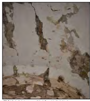
F03. Detalle de afectaciones en arco fajón de Coro e intradós de bóveda
