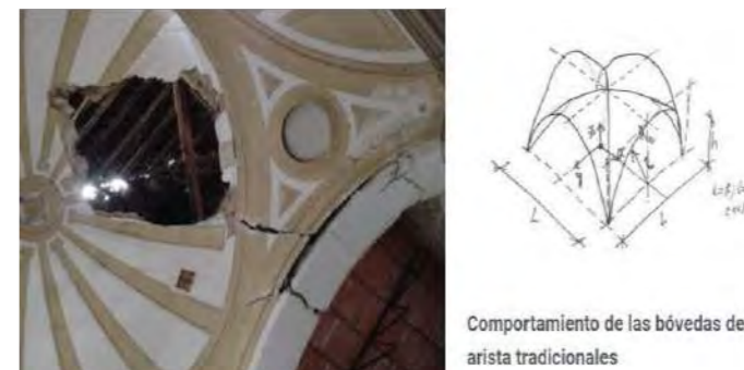
Imagen 19. Vista de la Cúpula dañada. Fuente: https://e-struc.com/2015/03/18/la-reparacion-de-una-cupula-de-fabrica/
