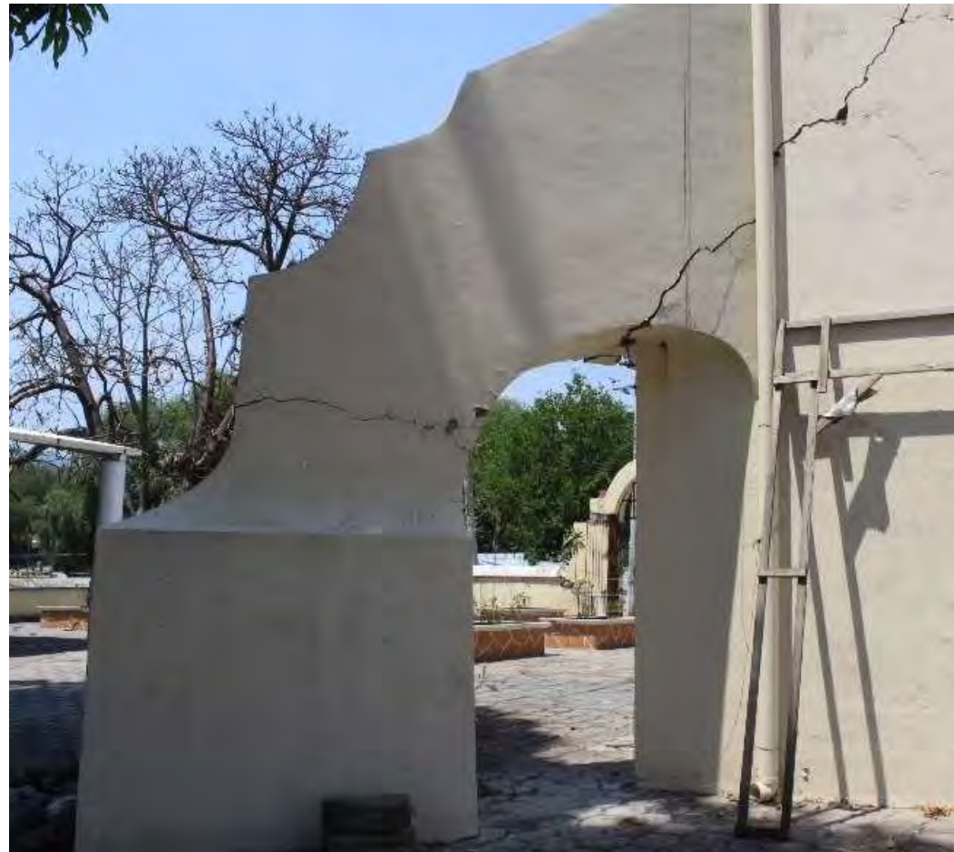
Agrietamientos en contrafuerte inclinado Templo de Santo Domingo, Ayotlacha, Puebla. Archivo del MAECPE, 2018.
