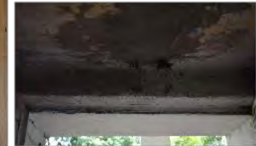
Imagen 3: Detalle del estado actual del intradós de dintel de puerta
