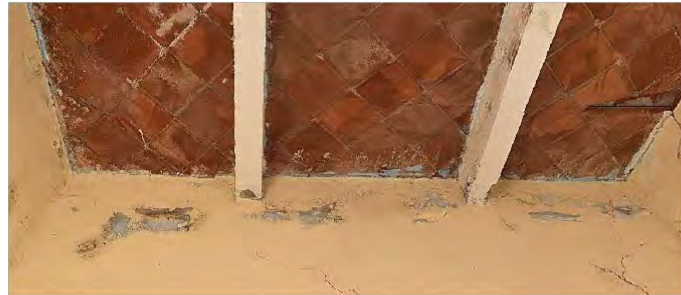
Imagen 2: Sección de intradós de cubierta con afectaciones
