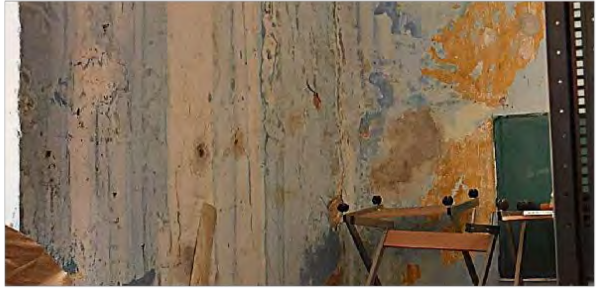
Imagen 2: Humedades principales daños en muro interior sur
