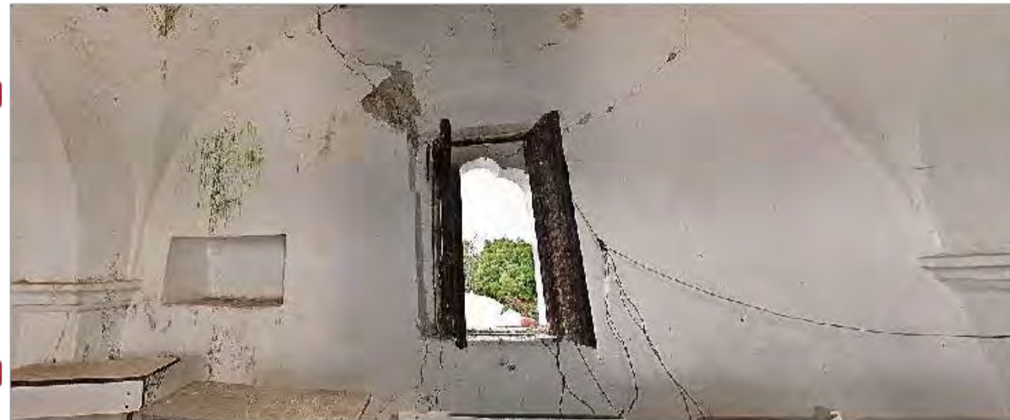
Imagen 1: Vista general de afectaciones presentes en muro interior poniente de Coro
