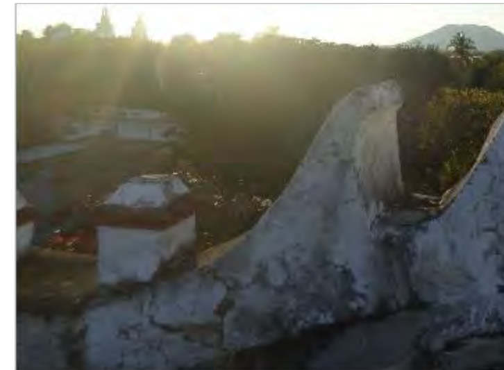
Imagen 2: Detalle de deterioros existentes en imafronte
