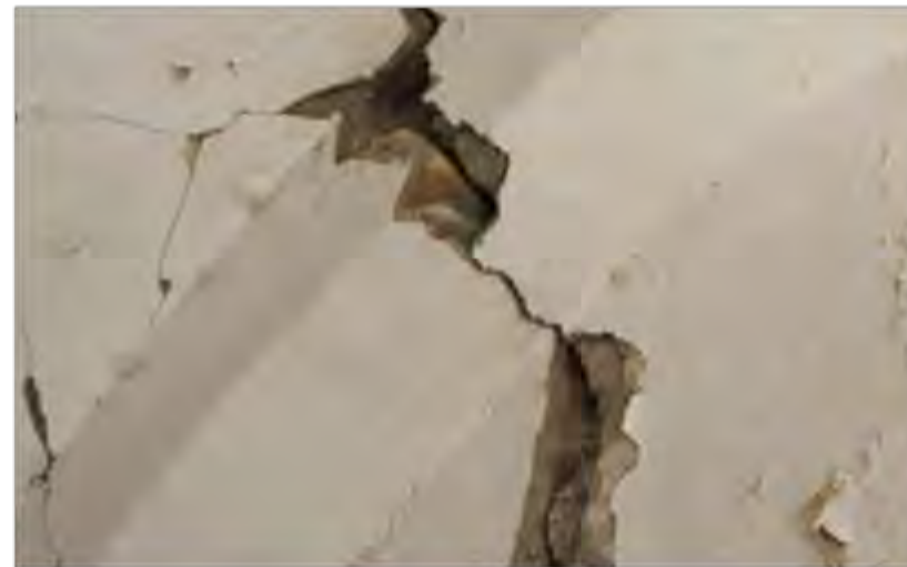
Imagen 1: Detalle de afectaciones en arco fajón de Coro
