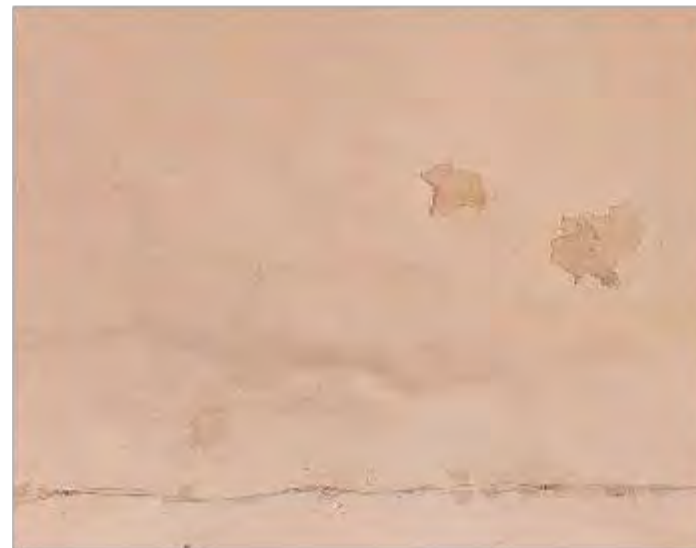
Imagen 2: Detalle de afectaciones presentes en intradós de bóveda
