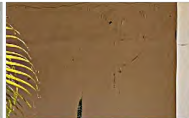
Imagen 3: Detalle de deterioros en muro exterior norte
