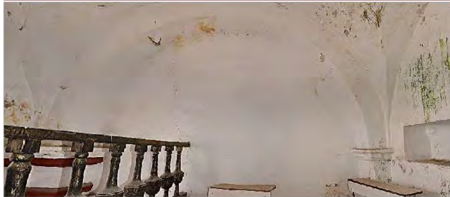
Imagen 1: Vista general de afectaciones presentes en muro interior sur de Coro
