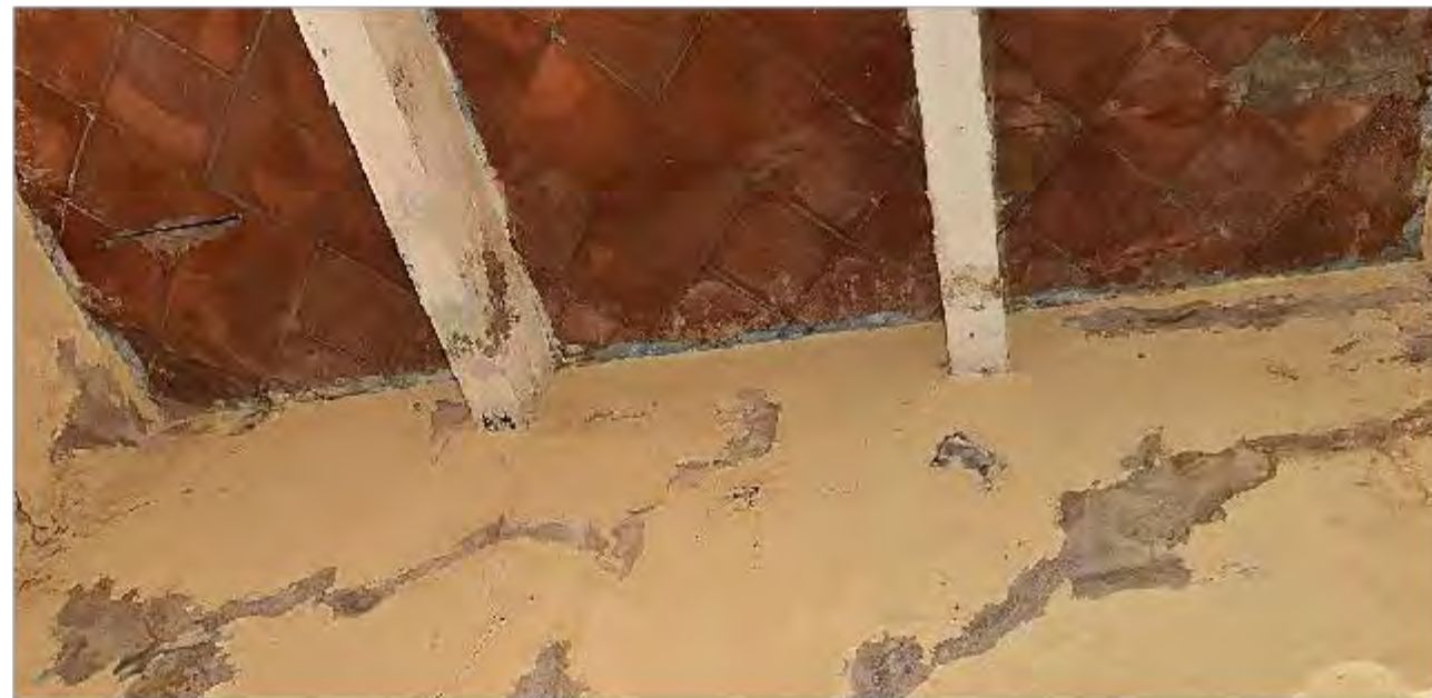
Imagen 2: Vista de afectaciones en intradós de cubierta
