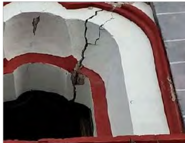
Imagen 2: Detalle de agrietamientos en ventana coral
