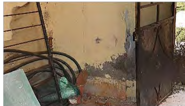
Imagen 2: Detalle afectaciones en muro interior norte
