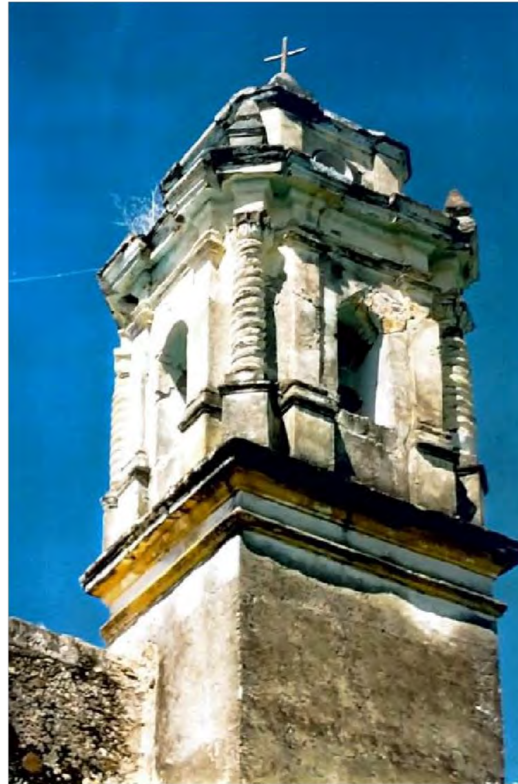
Imagen 1: Daños en segundo cuerpo de torre campanario lado nororient, producto del sismo del 15 de junio de del año 1999
