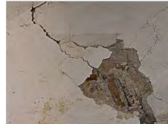
Imagen 3: Detalle de deterioros en intradós parte surponiente de bóveda de Coro
