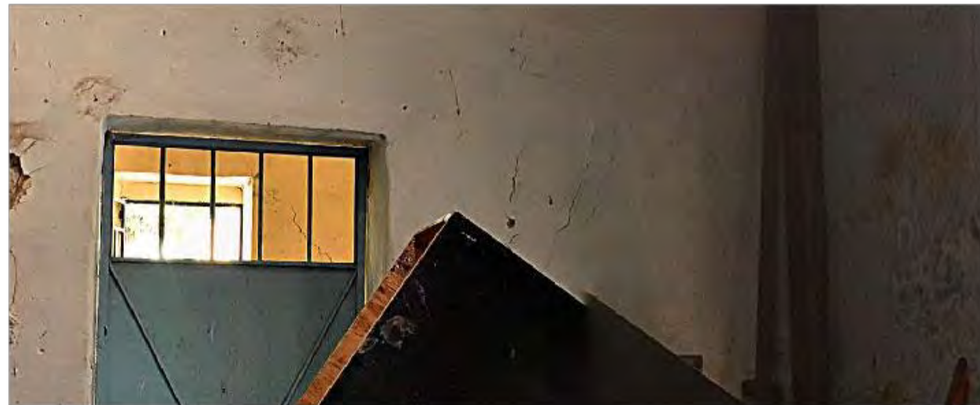
Imagen 2: Fisuras y humedades presentes en muro interior norte
