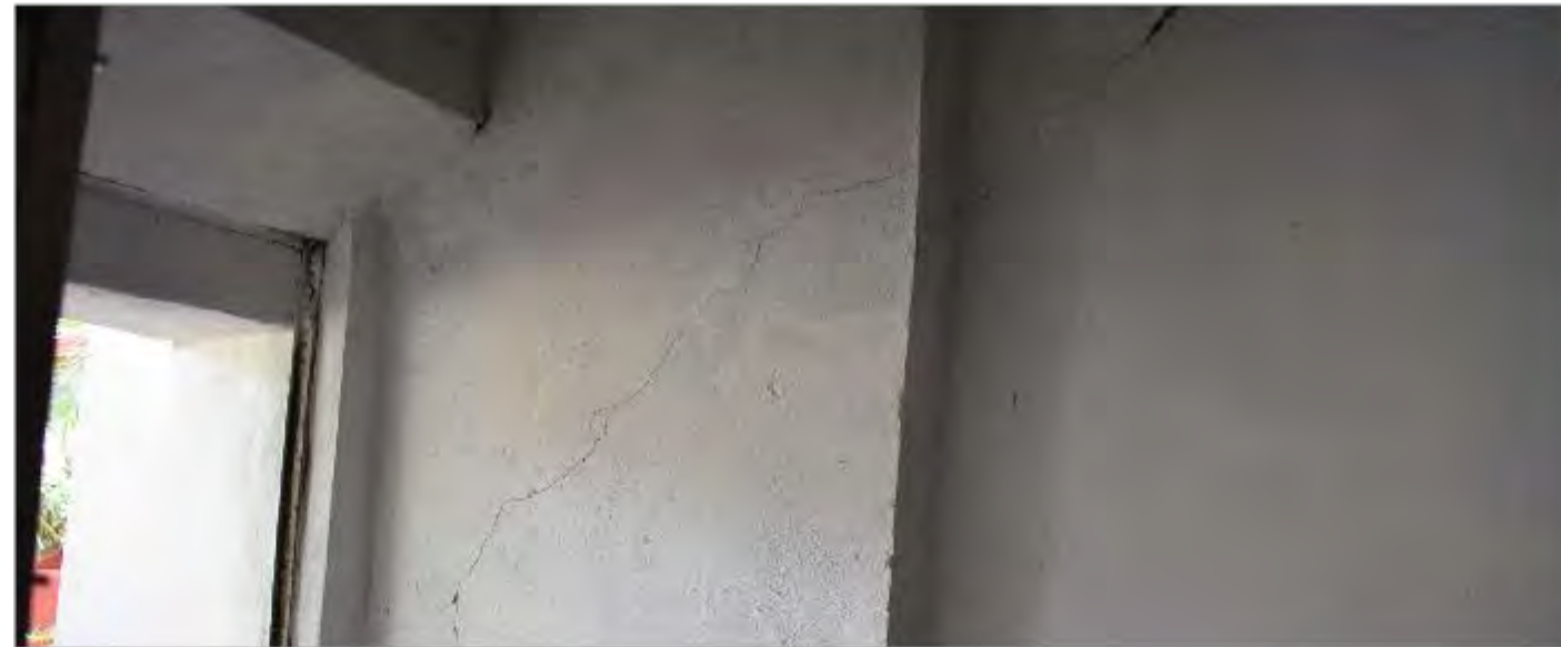
Imagen 1: Daños presentes en muro interior norte
