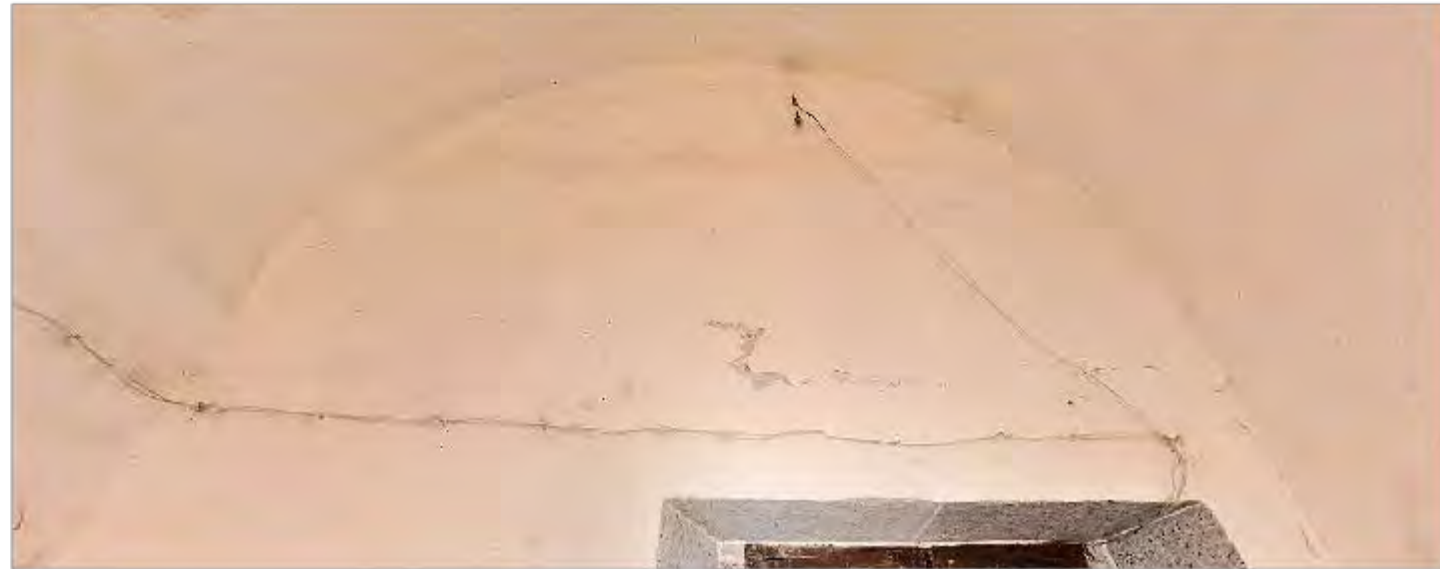
Imagen 1: Vista general de afectaciones en parte alta de muro interior norte
