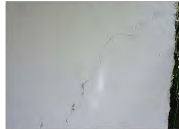
Imagen 3: Detalle de grietas y fisuras
