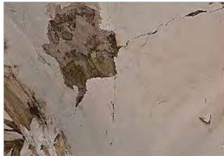
Imagen 2: Detalle de afectaciones en intradós parte suroriente de bóveda de Coro
