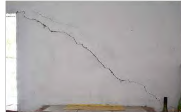
Imagen 3: Detalle de grieta en muro interior poniente
