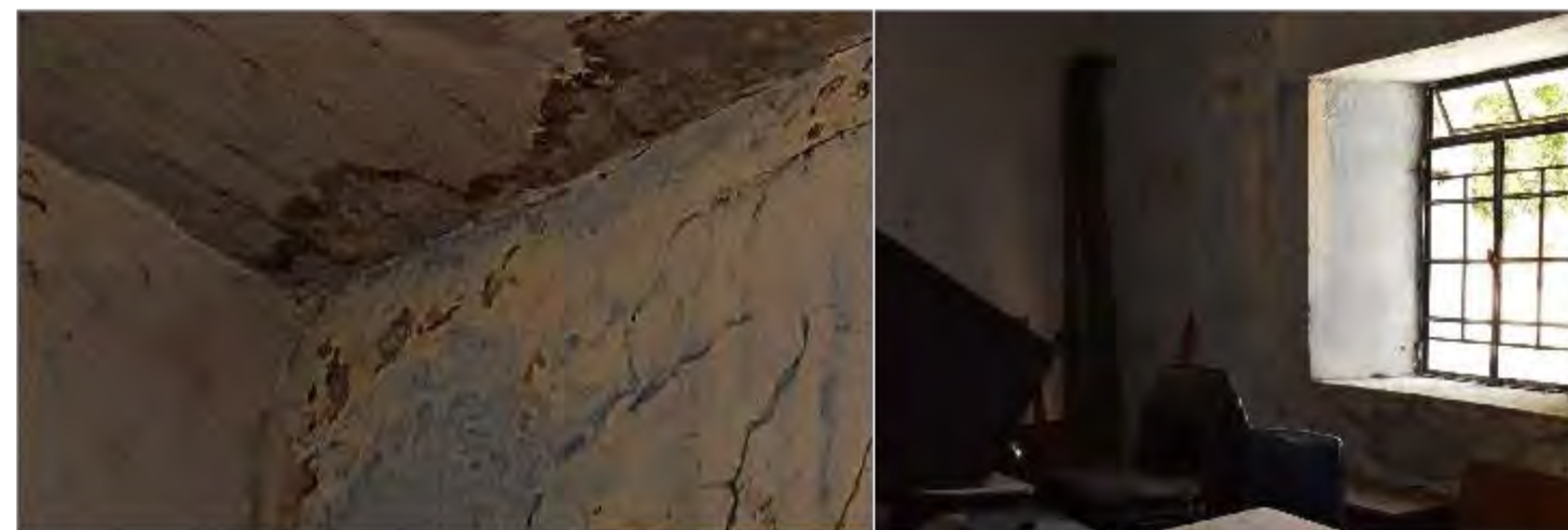
Imagen 2: Detalle de afectaciones en muro interior oriente y unión con cubierta
