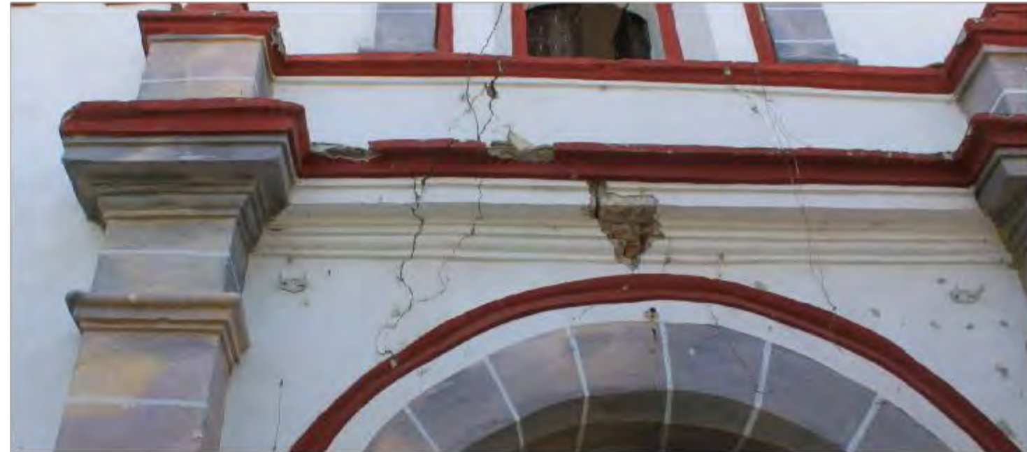
Imagen 1: Vista general de afectaciones en parte alta del primer cuerpo de fachada poniente
