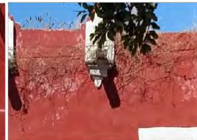
Imagen 3: Detalle de vegetación parásita en bajada de agua pluvial
