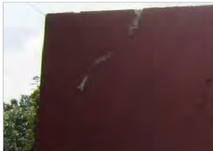
Imagen 2: Detalle de afectaciones presentes en muro exterior norte
