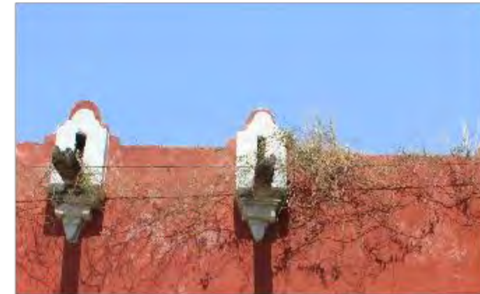
Imagen 3: Vegetación parásita y fisuras principales deterioros
