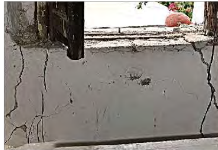
Imagen 2: Detalle de afectaciones en parte baja de muro interior poniente de Coro
