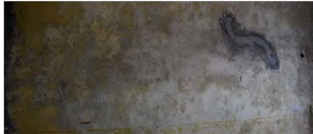
Imagen 2: Detalle del estado actual de parte baja de muro interior poniente
