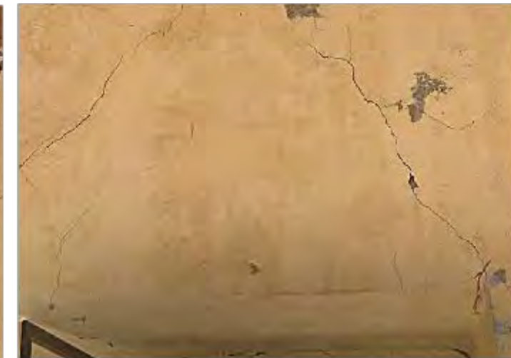
Imagen 3: Fisuras y agrietamientos en muro interior norte
