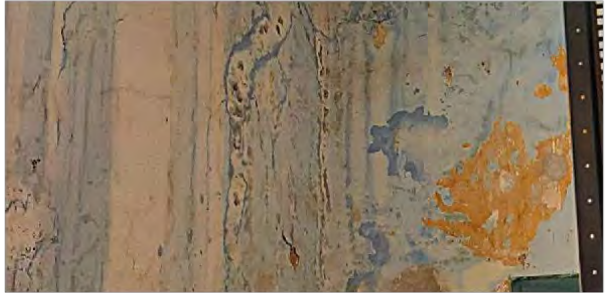
Imagen 1: Vista general de las afectaciones presentes en parte alta de muro interior sur
