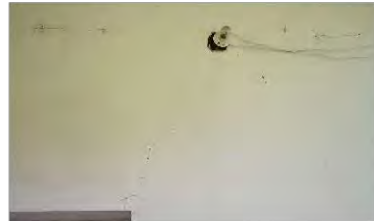
Imagen 2: Detalle de afectaciones presentes en muro exterior norte
