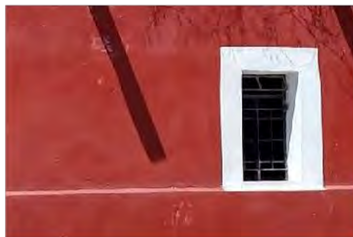
Imagen 3: Fisuras en muro exterior oriente
