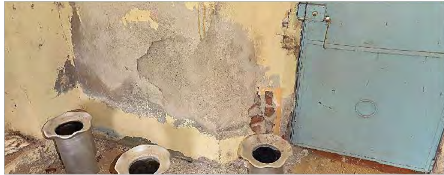
Imagen 1: Detalle de afectaciones presentes en parte baja de muro interior sur
