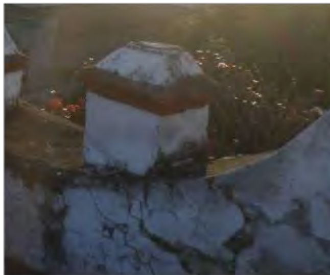
Imagen 3: Detalle de fisuras en remate de imafronte
