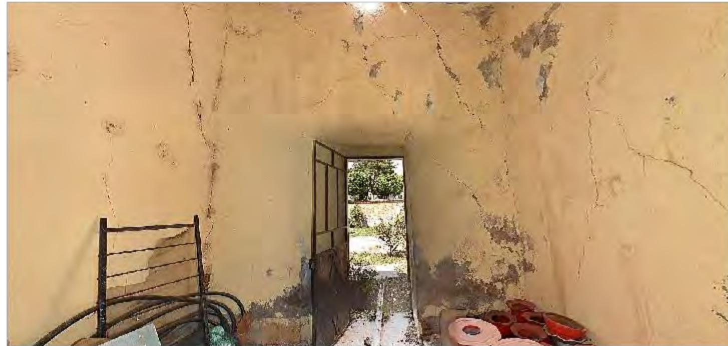
Imagen 1: Vista general del estado actual del muro interior norte
