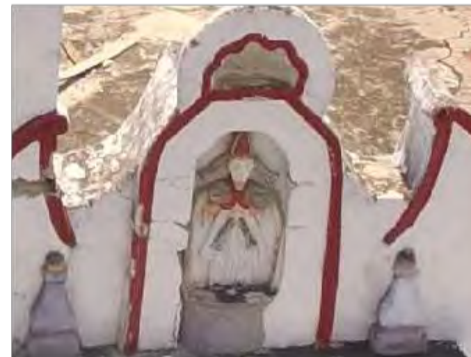
Imagen 3: Vista de deterioros en nicho
