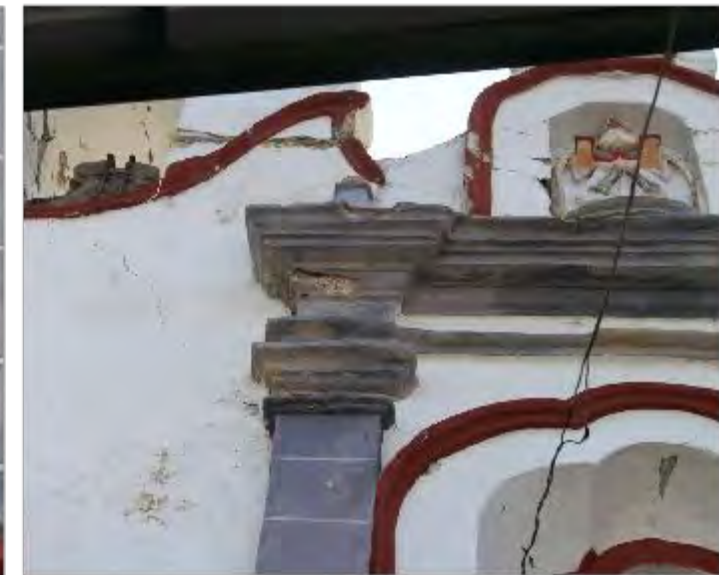
Imagen 3: Detalle de afectaciones en pilastra y muro
