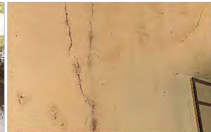
Imagen 3: Detalle de agrietamientos en muro interior norte
