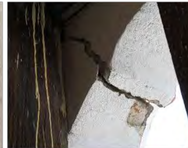
Imagen 2: Detalle de afectación en ventana coral
