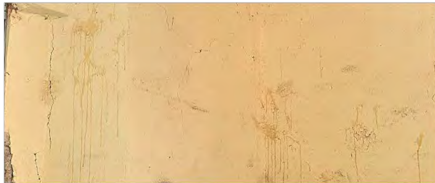
Imagen 2: Fisuras y agrietamientos principales daños en este sector del muro interior sur
