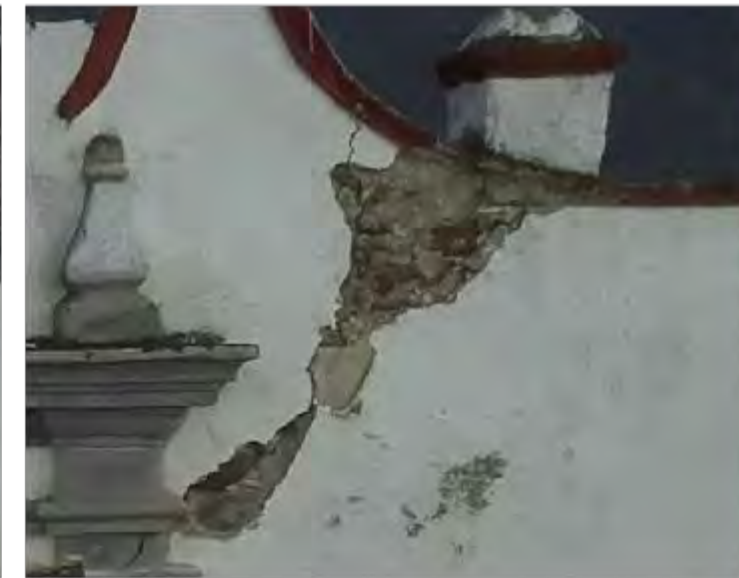
Imagen 2: Vista de afectaciones en imafrente fachada poniente
