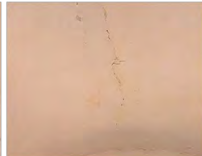
Imagen 3: Detalle de agrietamientos en intradós de bóveda
