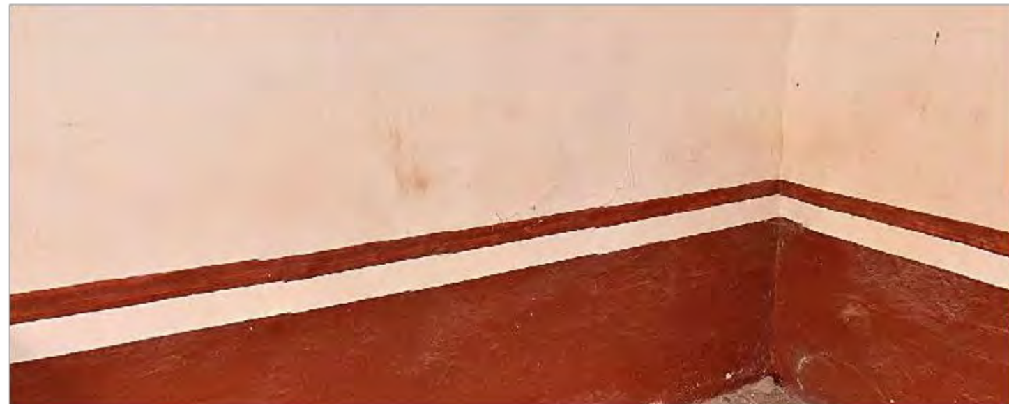
Imagen 2: Detalle de afectaciones en muro interior poniente
