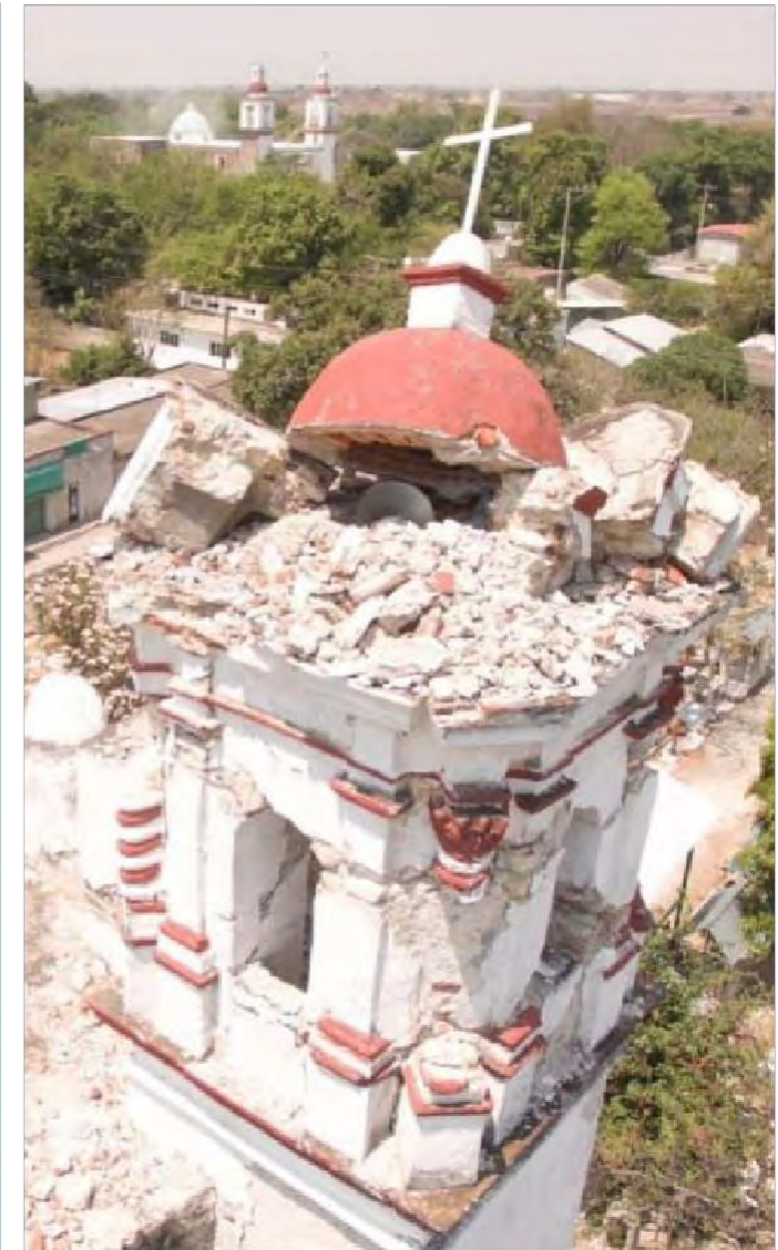
Imagen 2: Daños producidos en segundo cuerpo de torre campanario lado nororient, tras el sismo del 19 de septiembre del año 2017
