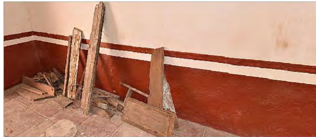
Imagen 1: Detalle de afectaciones en parte baja del muro interior poniente
