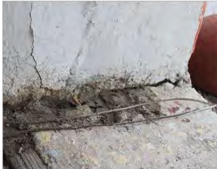
Imagen 3: Afectaciones presentes en muro de ventana coral
