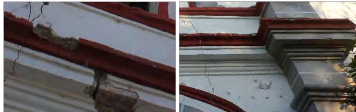
Imagen 2: Detalle de agrietamientos y daños en cornisas
