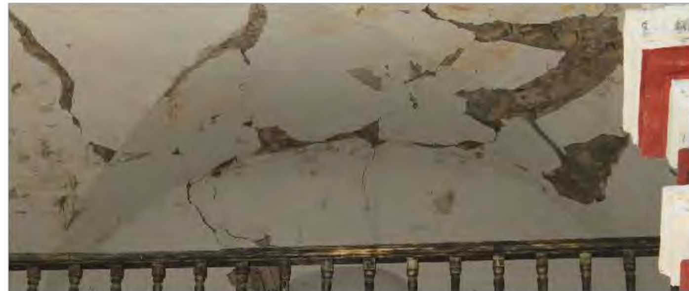
Imagen 3: Estado actual de bóveda por intradós de Coro, vista desde Nave tramo 2
