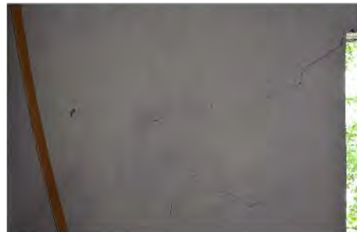
Imagen 2: Detalle de afectaciones presentes en muro interior poniente
