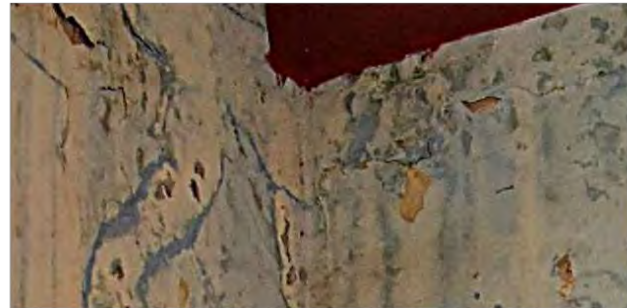
Imagen 2: Detalle de humedades y desprendimientos de recubrimiento en muro interior sur
