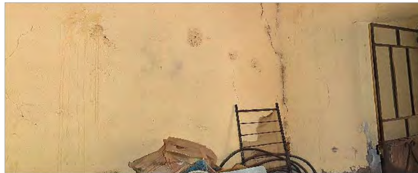
Imagen 2: Estado actual del muro interior poniente
