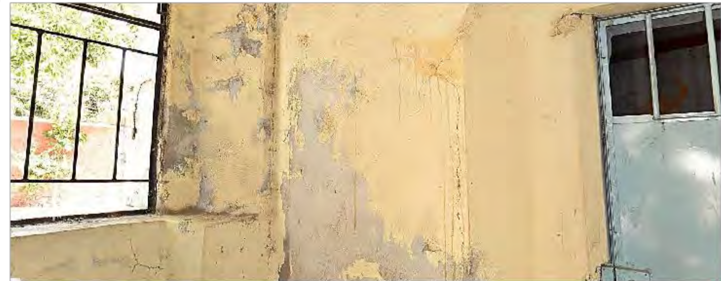
Imagen 2: Estado actual de muro interior sur
