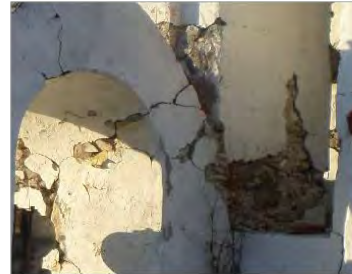
Imagen 2: Detalle de fisuras y agrietamientos en espadaña vista oriente
