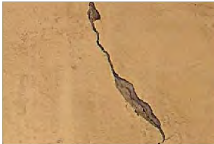
Imagen 2: Detalle de agrietamientos presentes en parte alta de muro interior norte
