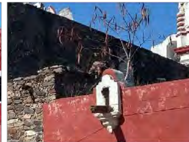
Imagen 3: Detalle del tipo de vegetación parásita visible desde el exterior oriente
