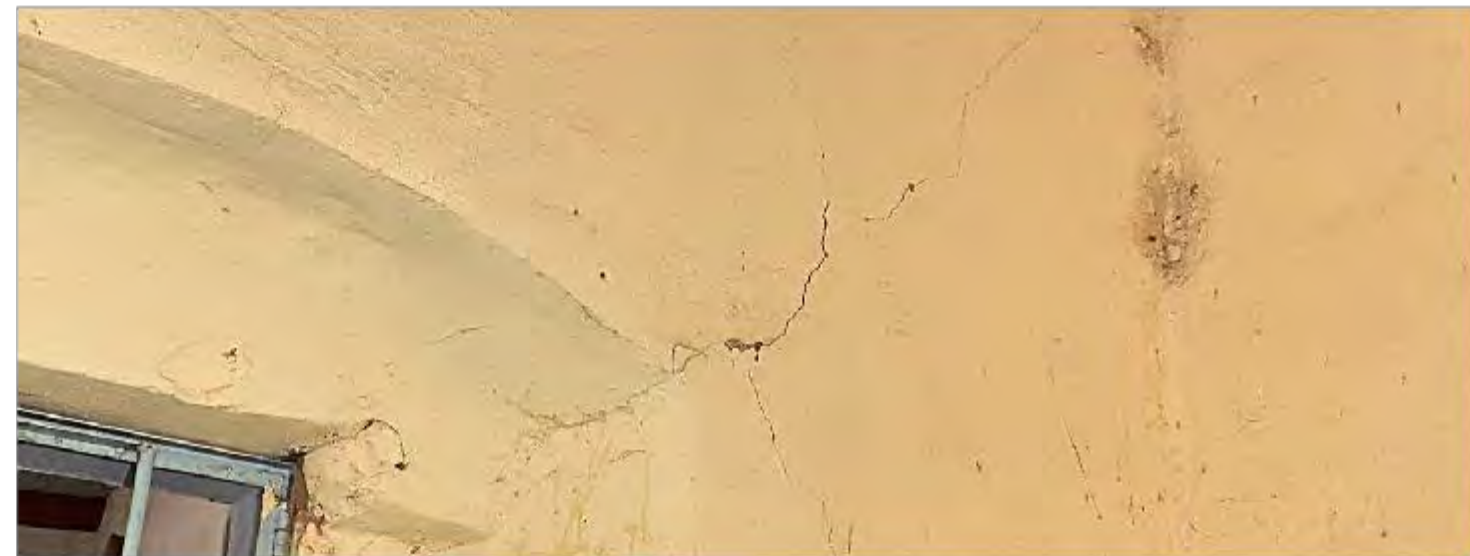
Imagen 2: Agrietamientos en muro interior sur
