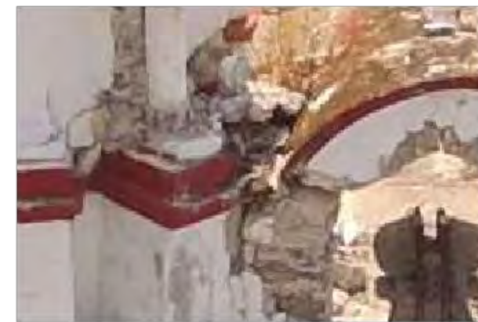
Imagen 3: Detalle de deterioros en espadaña
