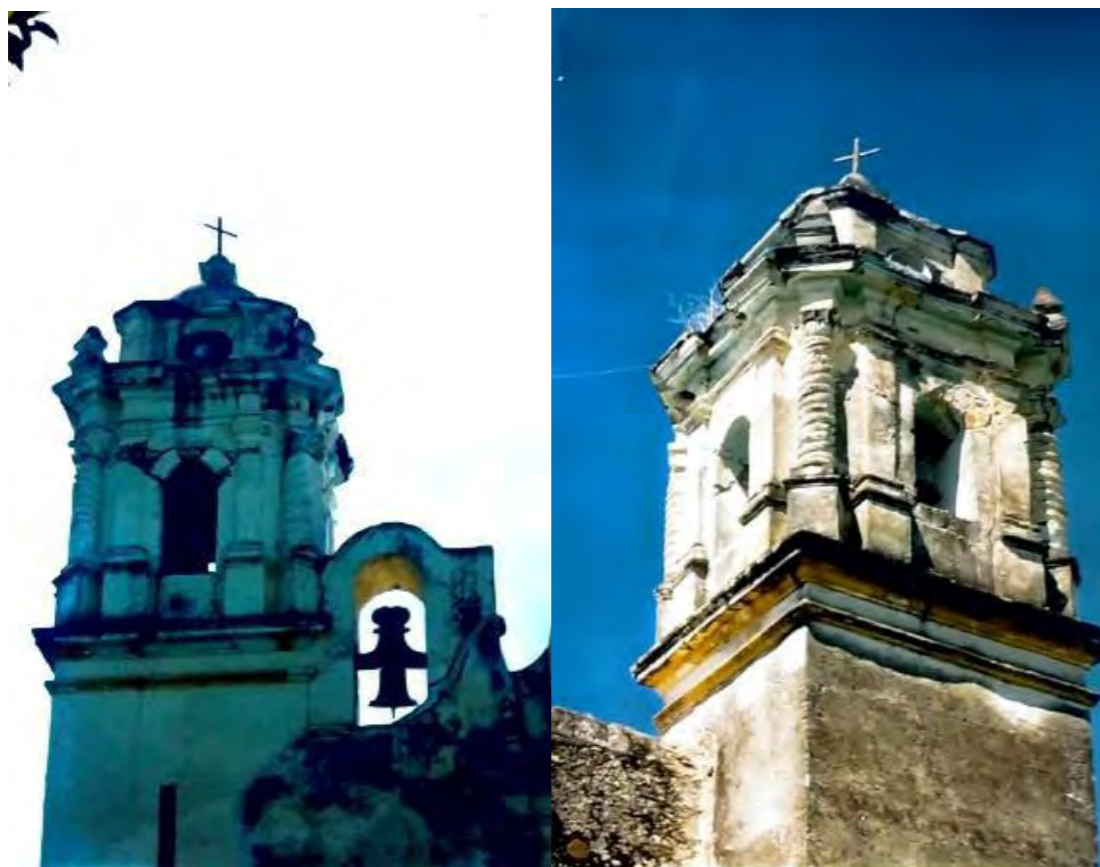
Imagen 7. Reporte fotográfico de los daños existentes en torre campanario tras el sismo del 15 de junio de 1999
