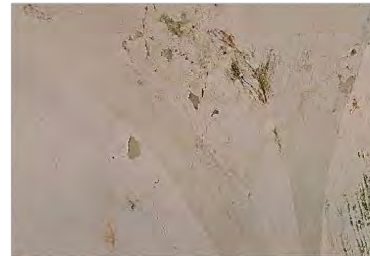
Imagen 3: Detalle de deterioros en intradós parte surponiente de bóveda de Coro
