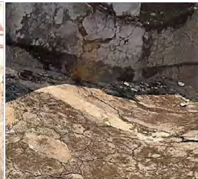
Imagen 2: Detalle de afectaciones presentes en cubierta por el extradós de Coro
