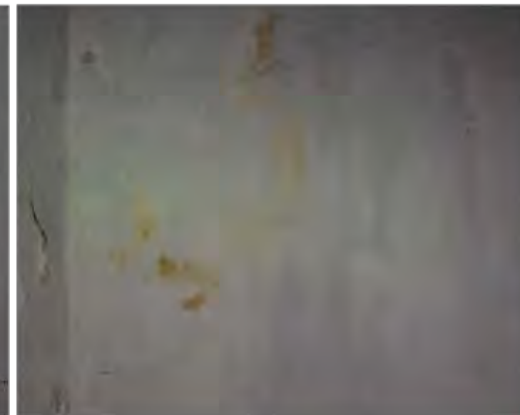
Imagen 3: Humedades en muro interior sur
