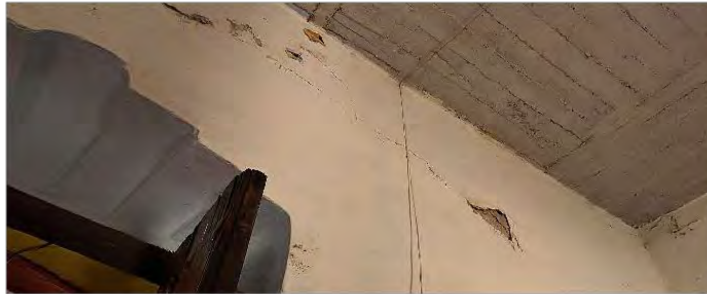
Imagen 1: Afectaciones en parte alta de muro interior poniente
