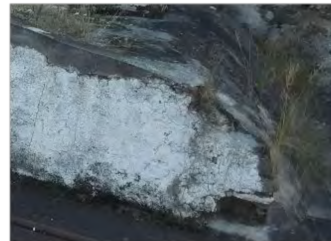
Imagen 2: Detalle de deterioros presentes
