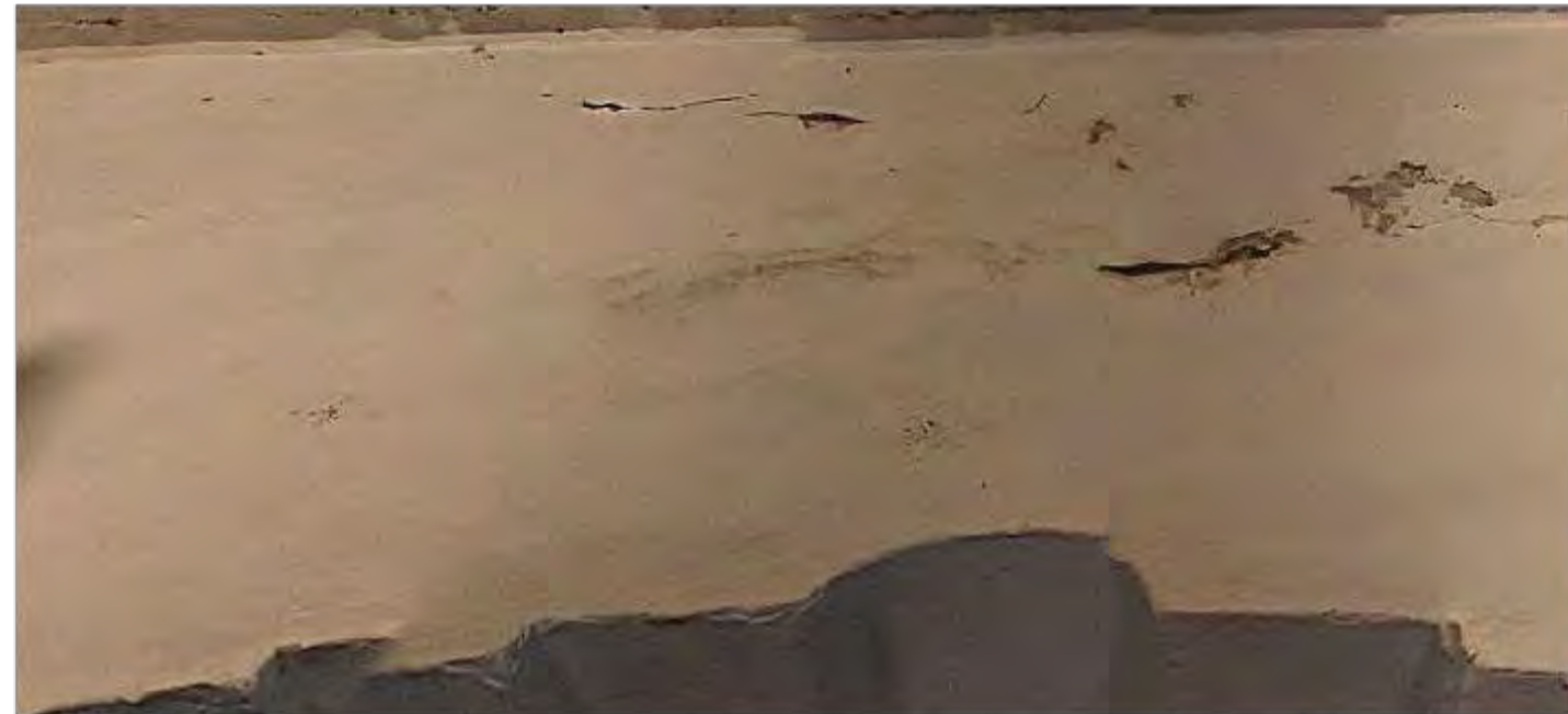
Imagen 1: Afectaciones presentes en parte alta de muro interior poniente
