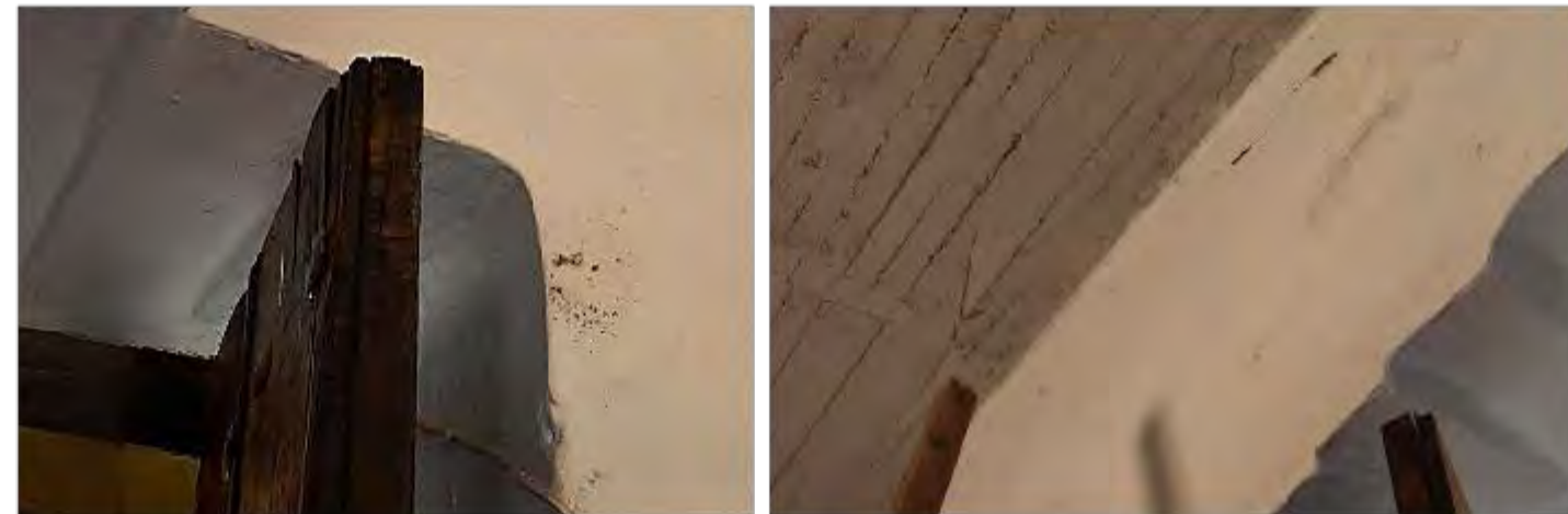
Imagen 2: Detalle de deterioro en muro interior poniente
