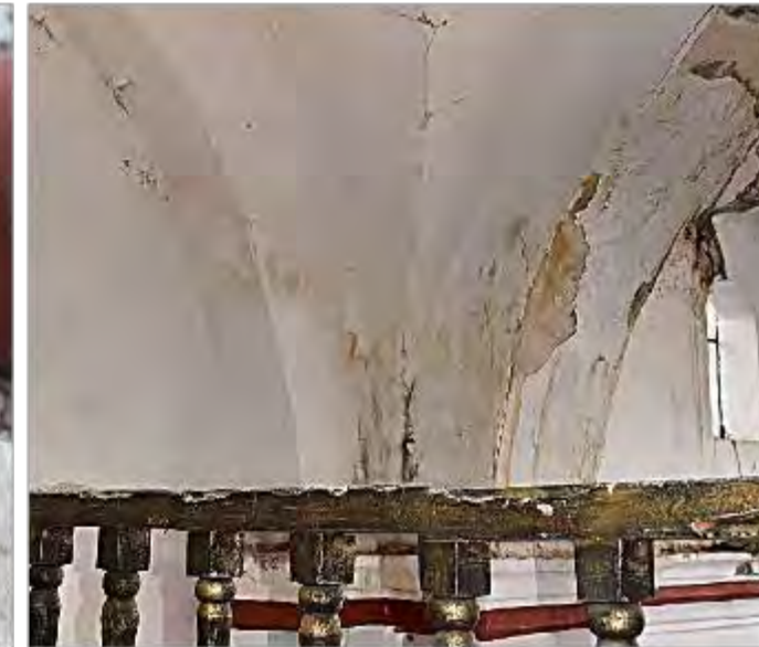
Imagen 4: Detalle de afectaciones en elementos del Coro
