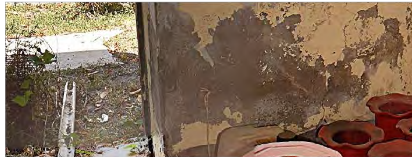
Imagen 2: Humedades y desprendimiento de recubrimientos principales afectaciones
