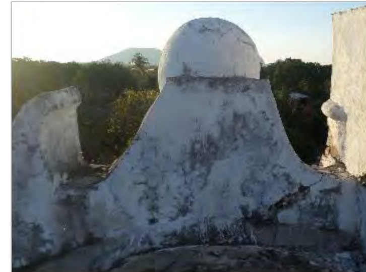
Imagen 4: Fisuras y desprendimiento de recubrimientos en fachada oriente de imafronte
