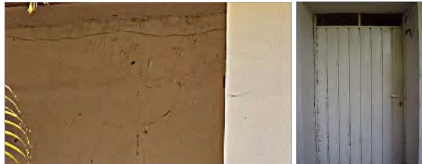
Imagen 2: Detalle de afectaciones en muro exterior norte
