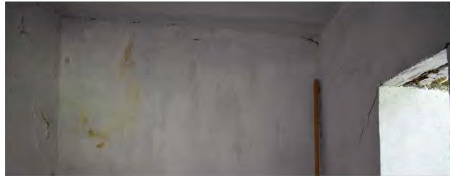
Imagen 1: Vista general de afectaciones en muro interior sur
