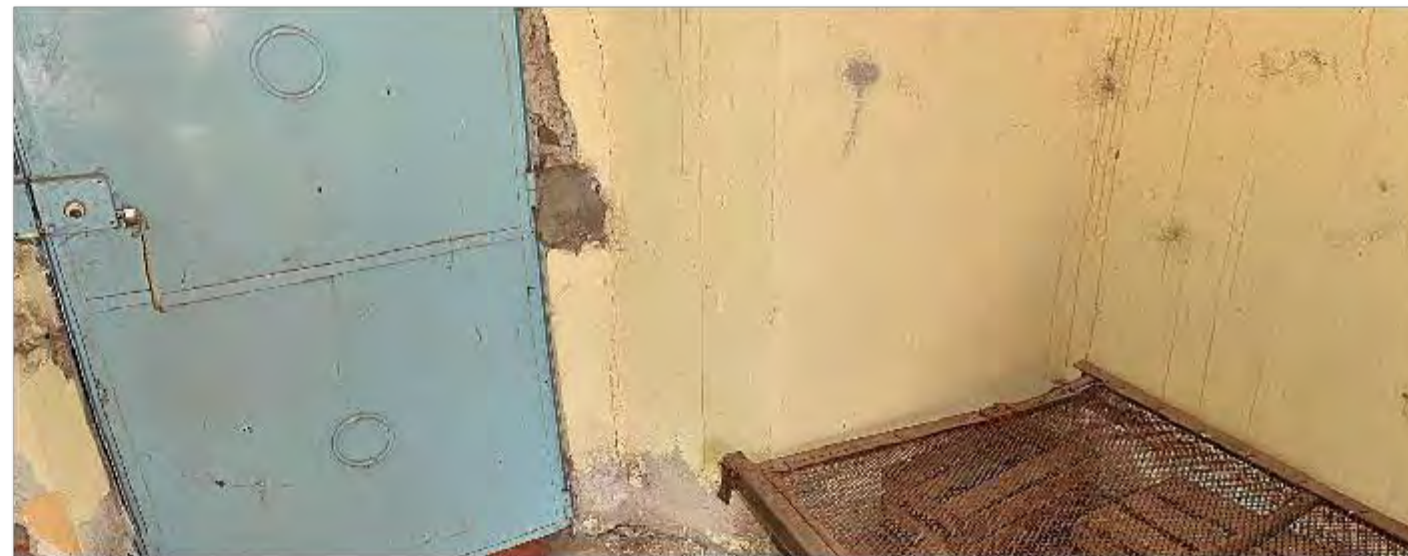
Imagen 1: Estado actual de parte baja de muro interior sur
