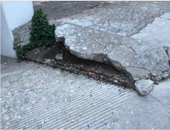
Pavimentos en mal estado
