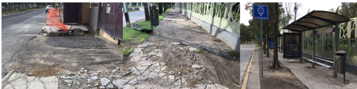
Figura 43 - 45. Estado de las calles y banquetas para acceder a las paradas de transporte público situadas sobre el Bulevar del Niño Poblano. Elaboración propia con base a recorridos en campo (2018).
