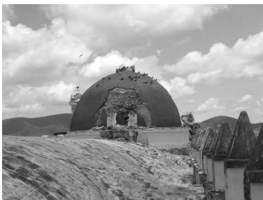
Figura 3.8. Afectaciones en el templo de Santo Tomás, Tlapanalá. Autor: Daniel Sánchez. (2018)
