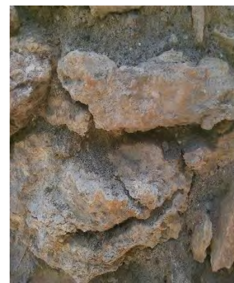
Figura 3.107. Detalle de muro y juntas erosionadas en el templo de Santiago Apóstol, Teopantlán. Autor: Daniel Sánchez. (2018)
