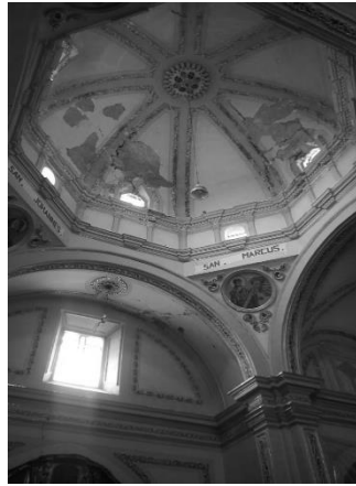
Figura 3.9. Afectaciones en el templo de Santiago Apóstol, Teopantlán. Autor: Daniel Sánchez. (2018).
