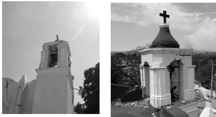
Figura 3.10-3.11. Afectaciones en el templo de Santo Domingo, Ayotliha. Autor: Daniel Sánchez. (2018)
