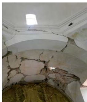
Figura 1.1-1.2. Afectaciones en el Decanato de Matamoros, tras el sismo del 19 de septiembre de 2017. San Felipe Xochiltepec. Autor: Daniel Sánchez. (2017).
