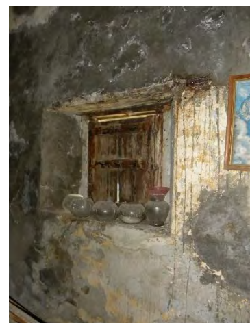
Figura 3.109. (2018). Afectación por madera por daño de insectos xerófilos. Autor: Daniel Sánchez. (2018)
