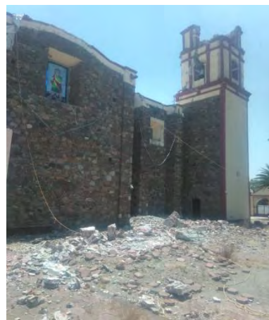
Figura 1.9-1.10. A dos años del sismo. A dos años del evento sísmico las acciones concretas hacia la restauración de estos bienes son escasas y en muchos de los casos nulas, dado que inclusive numerosos bienes presentan escombros. Templo de San Agustín Tepexco y San Bartolo Cohuecán. Autor: Daniel Sánchez (2018).
