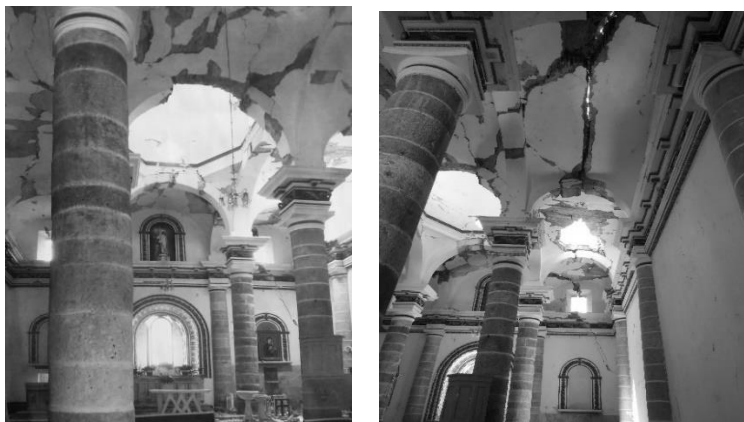
Figura 3.6-3.7. Afectaciones en el templo de la Virgen de Ocotlán. Autor: Daniel Sánchez. (2018)
