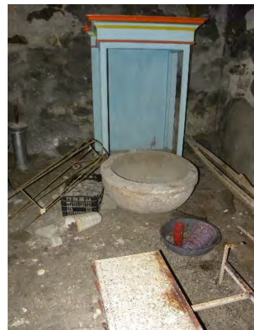
Figura 3.108. Afectación por heces fecales. Autor: Daniel Sánchez. (2018)
