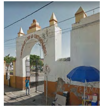
Figura 2.44. Estado actual de la arcada y barda atrial del Convento de Santo Domingo de Guzmán, Izúcar. Autor: Daniel Sánchez. (2017).
