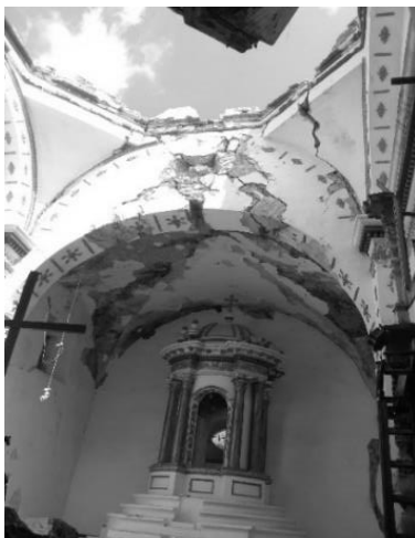
Figura 1.8. Adecuaciones en el templo de San Agustín. Uno de los problemas que enfrenta el patrimonio arquitectónico del Decanato de Matamoros, es la adaptación y modificación informal de los espacios y dimensiones de los inmuebles, ya sea para adecuarlos a nuevos usos o necesidades, corregir desperfectos, o bien para integrar nuevos elementos. Uno de los casos representativos de lo anterior, es el templo de San Agustín Tepexco, donde los arcos del crucero en las claves y riñones denotan la integración de material de relleno, para alcanzar un peralte mayor, y con ello posibilitar la conformación de pechinas sobre las que descargar una cúpula añadida en otra etapa constructiva. Autor: Daniel Sánchez (2017).
