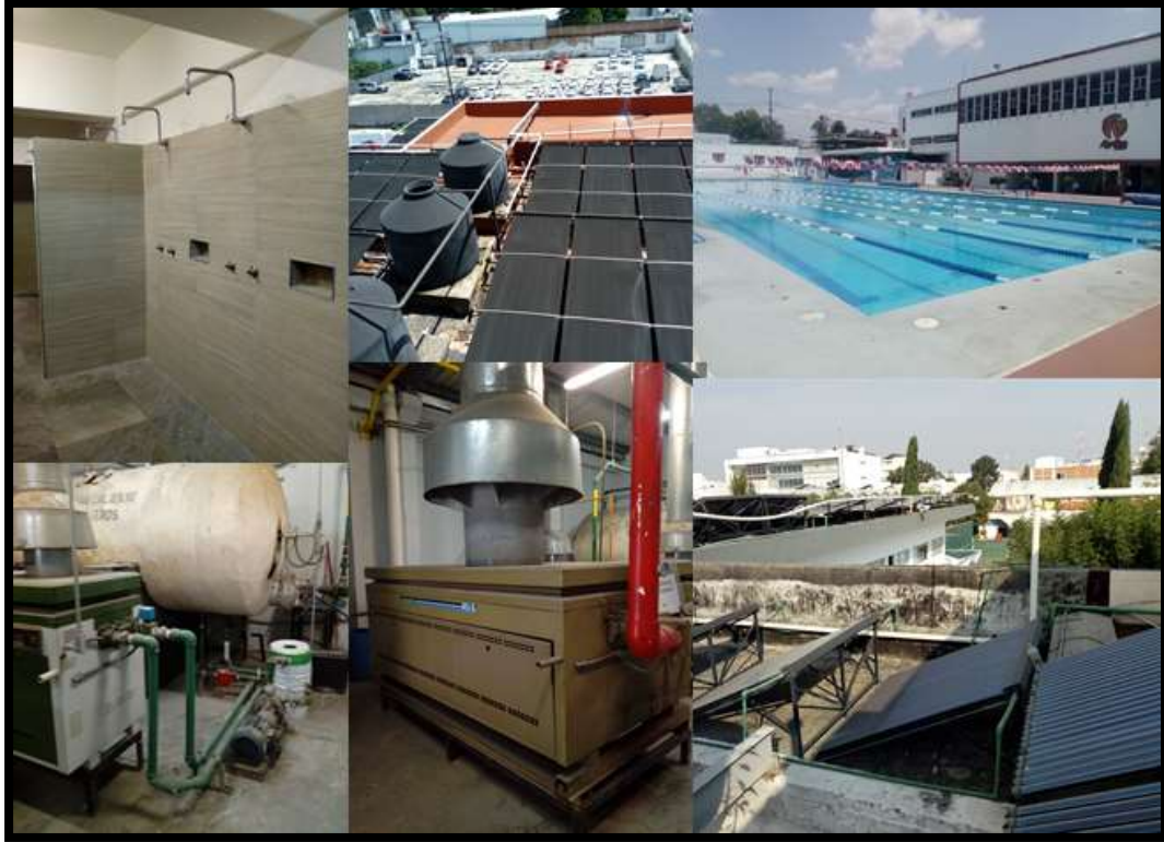
Figura 3. Instalaciones de los sistemas en la UPAEP. Fuente propia 2020.
