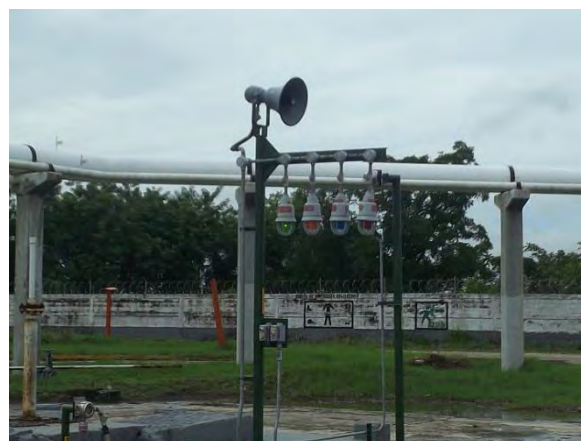
Figura 6. Alarmas Audibles y Visibles en instalaciones petroleras de la región sur
