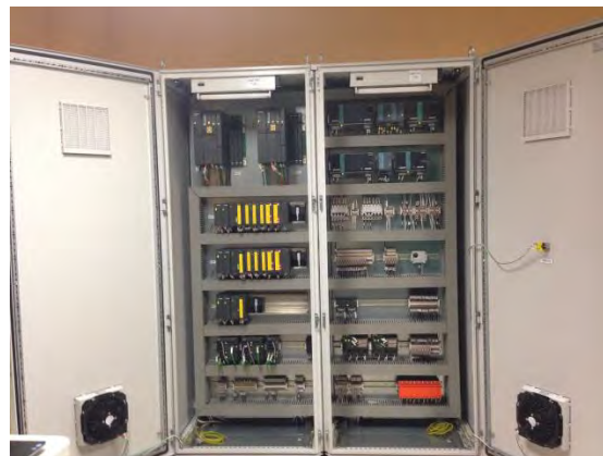
Figura 4. Control Electrónico programable en instalación petrolera de la región sur
