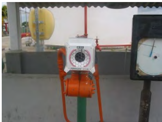
Figura 3. Detector de Fuego en instalaciones petroleras de la región sur
