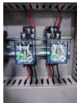
Figura 6. Relevadores conectados en el Módulo Didáctico.
