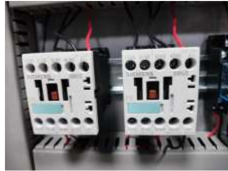
Figura 8. Contactores en el Módulo Didáctico.
