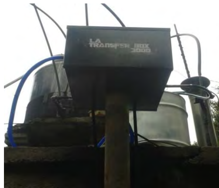
Figura 3.-Instalación del recuperador de calor en chimenea de estufa de leña
