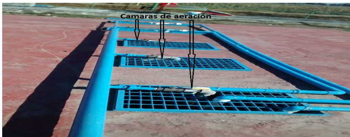
Figura 2. Cámaras de aeración.
