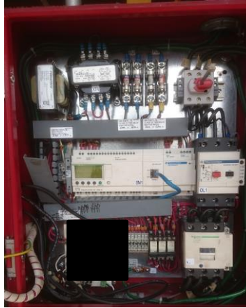
Figura 6.-Vista interna del controlador de la bomba jockey.
