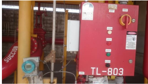
Figura 10.-Nuevo sistema de control instalado.
