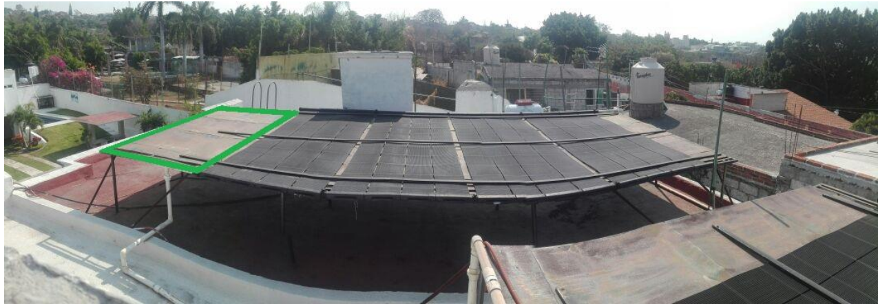
Figura 1. Foto del Sistema de Calentador Solar de Agua para Alberca.
