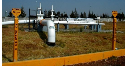
Figura 2. Señalización de ductos subterráneos.
