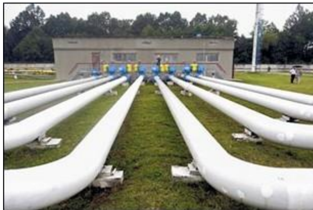
Figura 1. Ductos en función a la intemperie
