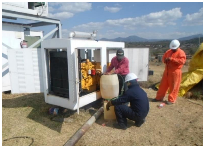
Figura 6. Generador habilitado para puesta en marcha de motor de bomba de recirculación.
