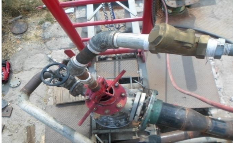
Figura 7. Imagen del cabezal del sistema air- lift ya instalado.
