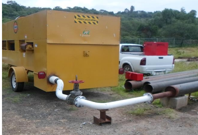
Figura 3. Instalación de tubería y válvula de compuerta a la entrada de la unidad de enfriamiento.
