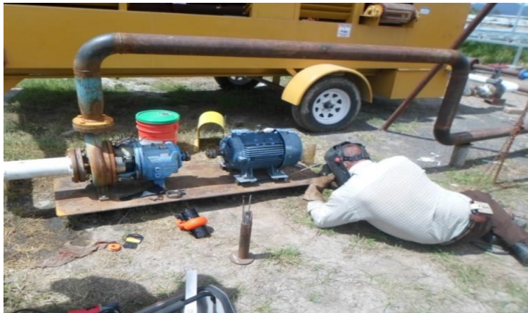
Figura 4. Instalación de tubería de salida y colocación de placa de acero como base para bomba y motor de recirculación.
