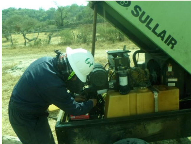
Figura 8. Compresor utilizado para realizar las pruebas con sistema air- lift.
