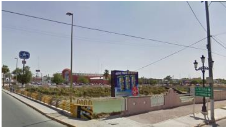
Imagen 3. Vista Actual del Canal y muestra del estado general de los taludes.
