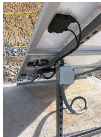
figura 6. Modulo Fotovoltaico de 150 wats.
