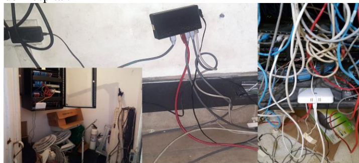
Figura 2. Estado del Hospital
