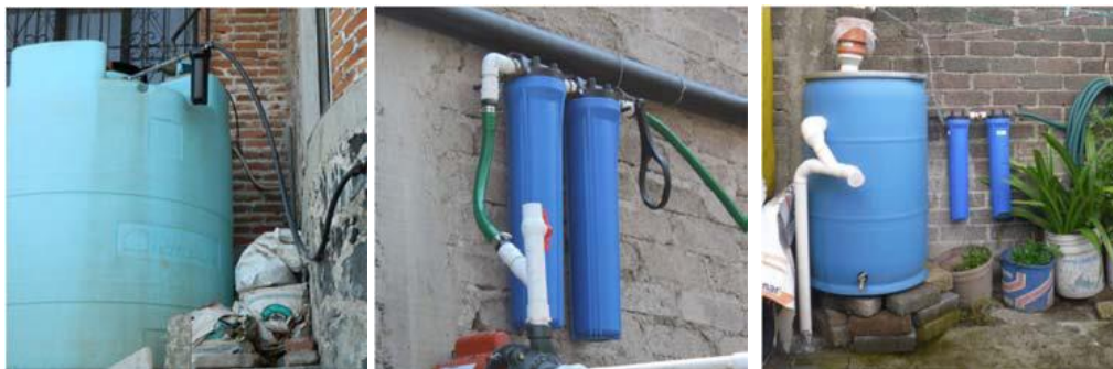
Figura 1,2 y 3 Sistema de captación de agua pluvial
