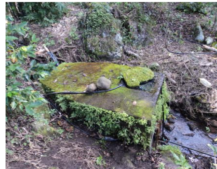
Figura 4. Tanque de regulación
