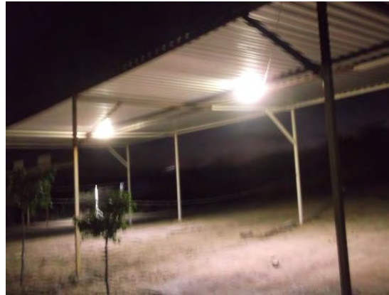
Figura 7. Lámparas de LED's funcionando con el SSFV.
