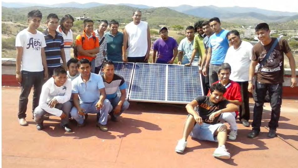
Figura 6. Módulo de paneles solares instalado.
