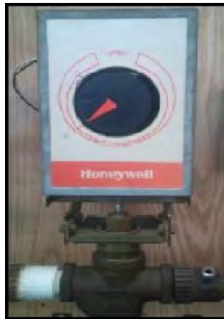
Figura 5. Válvula de control Honeywell.
