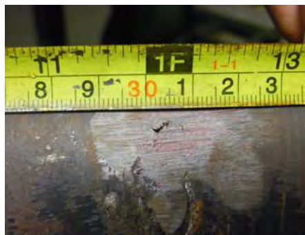
Figura 6 Dimensiones de la grieta
