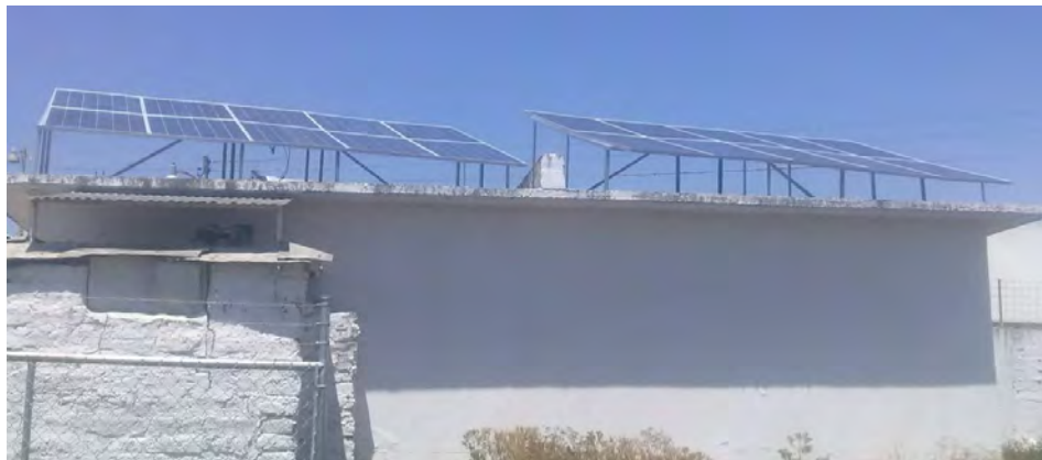
Figura 4. Vista frontal del arreglo fotovoltaico.
