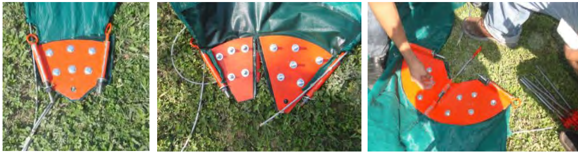
Figura. 19, 20 ,21. Observamos que las uniones están reforzadas con una membrana de lona, este ayudara a absorber la tensión que puede ocasionar las uniones metálicas en la membrana. Fuente: Morales (2014).
