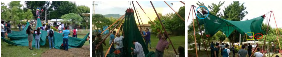
Figura. 22, 23, 24. Observamos el proceso del primer montaje, el cual tuvo fallas por la mala unión concurrente de los puños metálicos al anclaje de los postes y ocasiono que la velarías estuviese arrugada en algunas partes. Fuente: Morales (2014).
