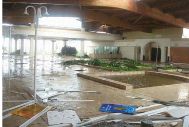
Foto 16 Daños en el interior del Hotel Melía cayo Coco. Cuba, por penetración del mar producto del huracán Irma 2017. No hubo daños a la estructura por tener fachada abierta
