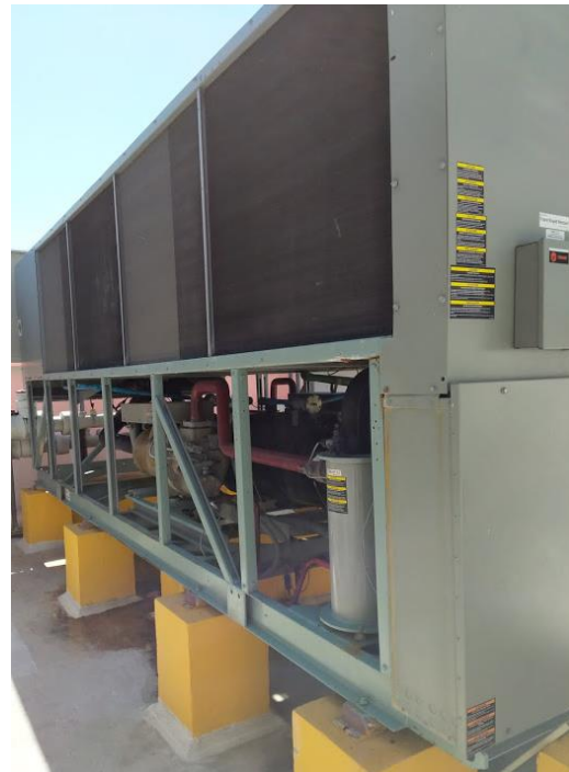
Imagen 2. Chiller 2 (imagen del autor)
