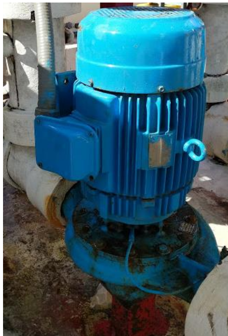
Imagen 3. Bomba secundaria 1 (imagen del autor)
