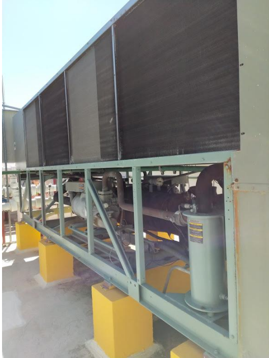
Imagen 1. Chiller 1 (imagen del autor)
