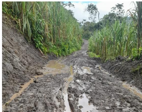
Figura 2. Evidencia mal estado de la vía.
