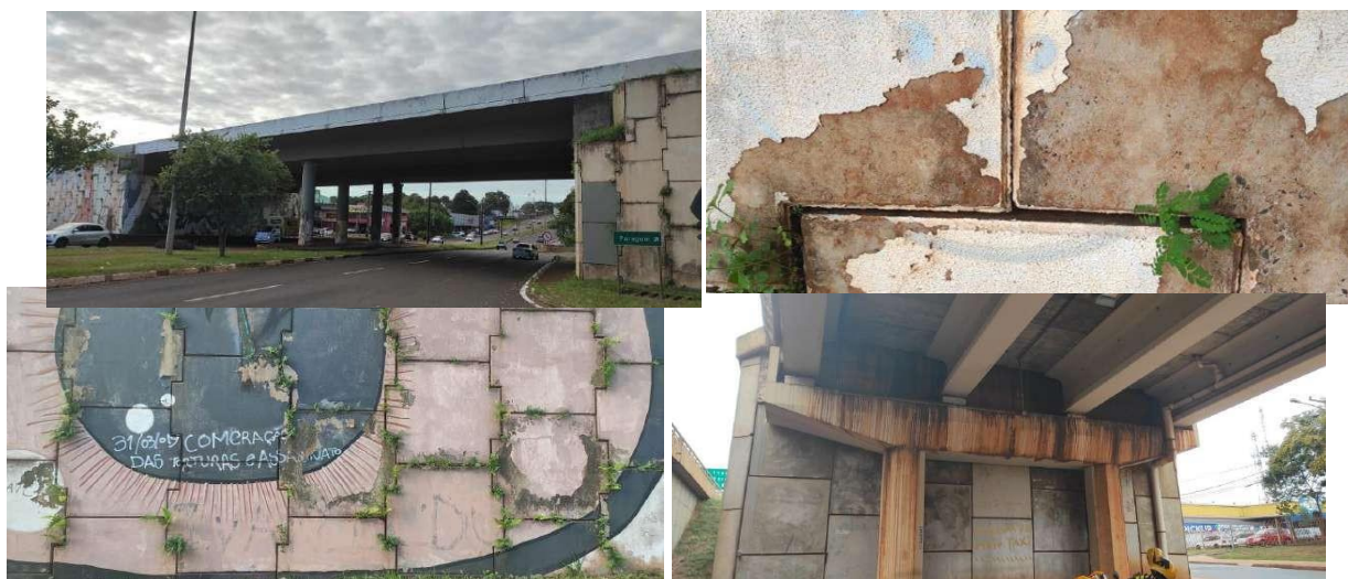
Figura 4. Morfología del viaducto y ejemplos de manifestación patológica. (OAE I)
