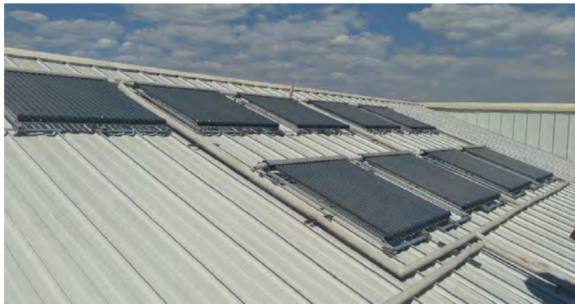
Figura 12 Colectores solares del tipo Heat-pipe o de flujo indirectos instalados en el techo.
