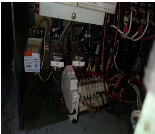
Figura 6 Máquina con control de lógica cableada
