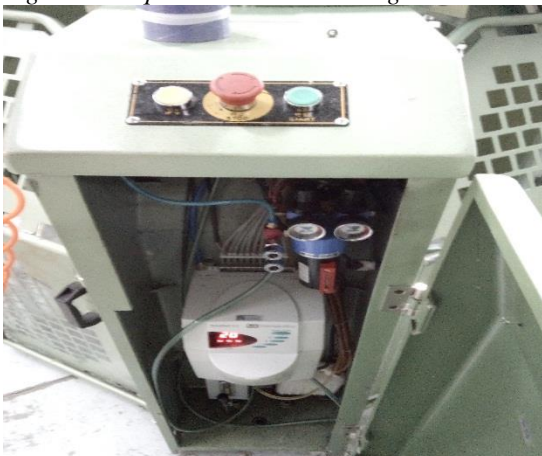
Figura 8 Variador de velocidad colocado
