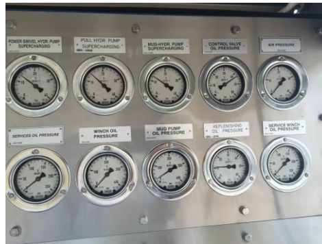
Figura 1. Tablero con indicadores analógicos de parámetros de perforación.
