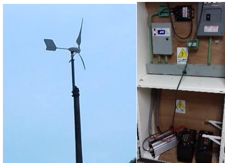
Figura 1.- Instalación de un sistema eólico autónomo en el Instituto Tecnológico de Acapulco
