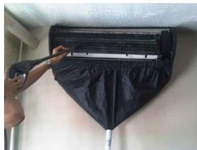
Figura 4. Forro para captar agua en el mantenimiento.
