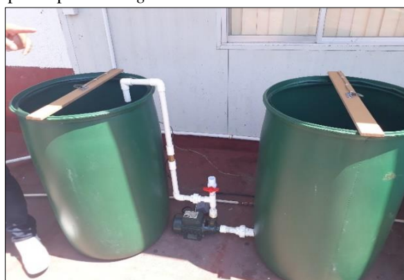
Figura 4. Descripción gráfica de los contenedores de agua y la bomba de rebombeo de agua
