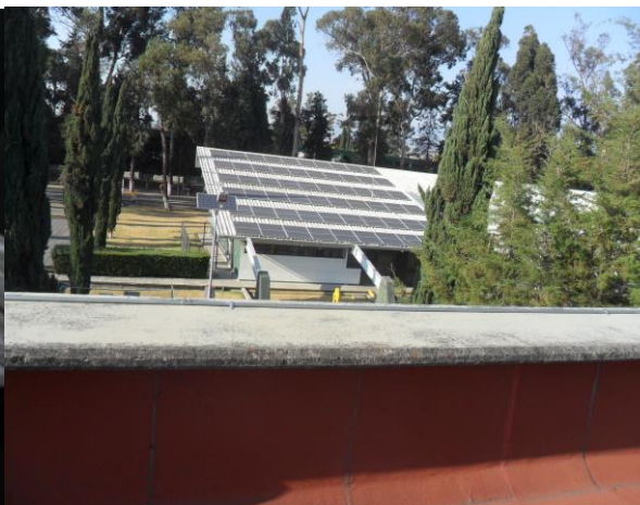
Figura 9 Celdas Fotovoltaicas instaladas
