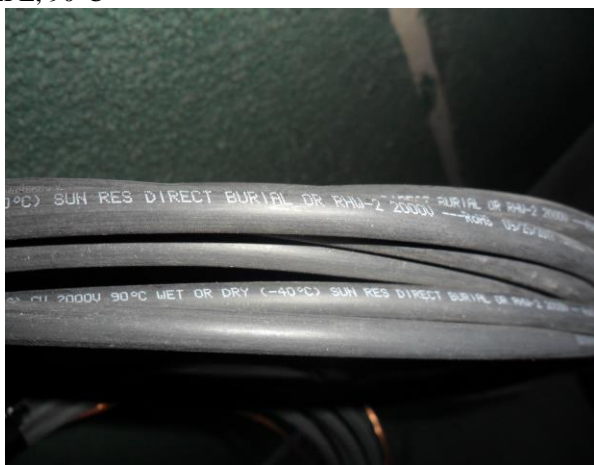
Figura 8 Cable para alimentar las celdas fotovoltaicas
