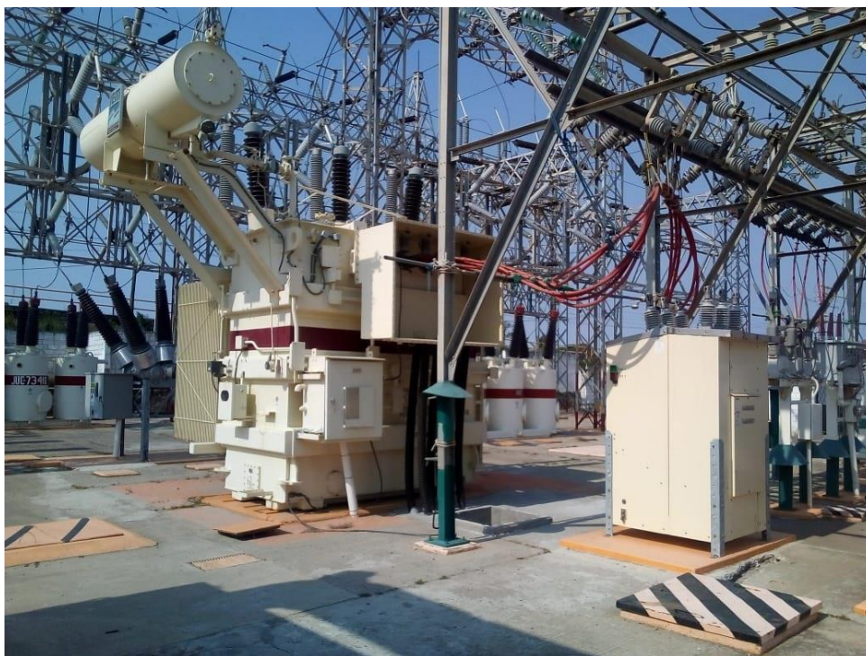
Figura 1. Transformador de potencia.
