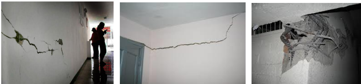
Imágenes 7 Fallas Estructurales
