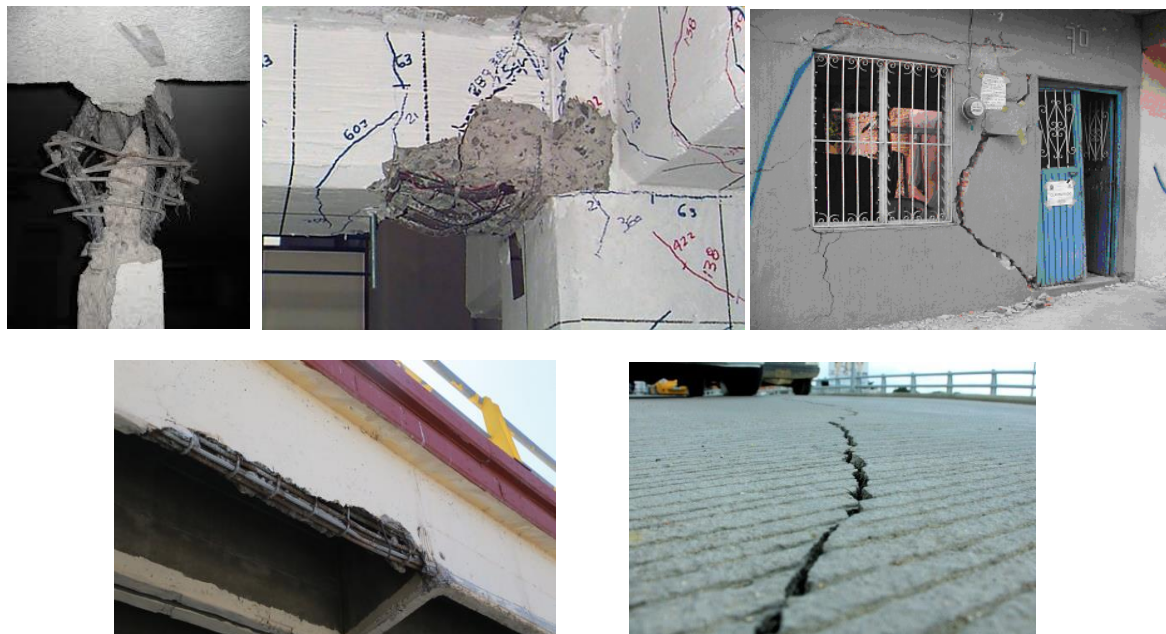
Imágenes 8 Fallas Estructurales
