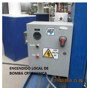
Figura 14. Control local Bomba Criogénica.
