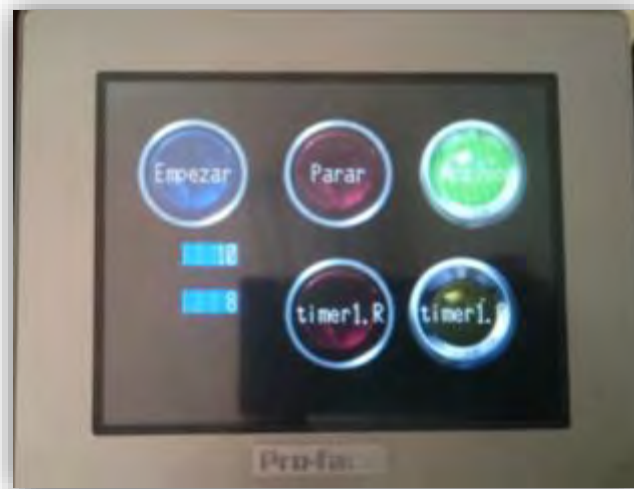
Figura 8. Implementación del programa en el PLC+HMI.
