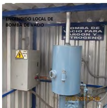
Figura 13. Control local Bomba de Vacío.
