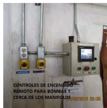
Figura 15. Control remoto de Ambas Bombas cerca de manifold .
