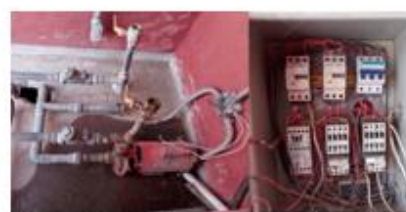
Figura 8. Bomba y gabinete de Cisterna D
