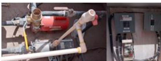
Figura 7. Bomba y gabinete de Cisterna H
