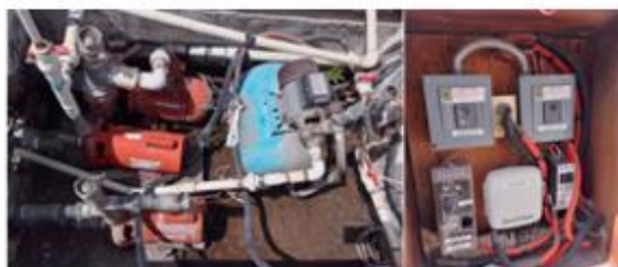
Figura 5. Bomba y gabinete de Cisterna E
