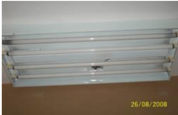
Figura No.3 Luminaria existente 4 x 39 W
