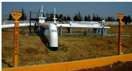
Figura 2. Señalización de ductos subterráneos.
