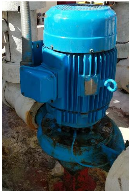
Imagen 3. Bomba secundaria 1 (imagen del autor)
