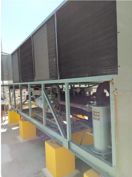
Imagen 1. Chiller 1 (imagen del autor)
