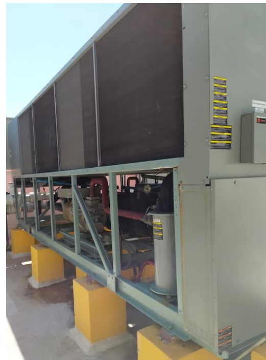
Imagen 2. Chiller 2 (imagen del autor)
