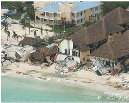
Foto 1: Efectos de oleaje de Huracán Wilma sobre hotel en Playa del Carmen.
