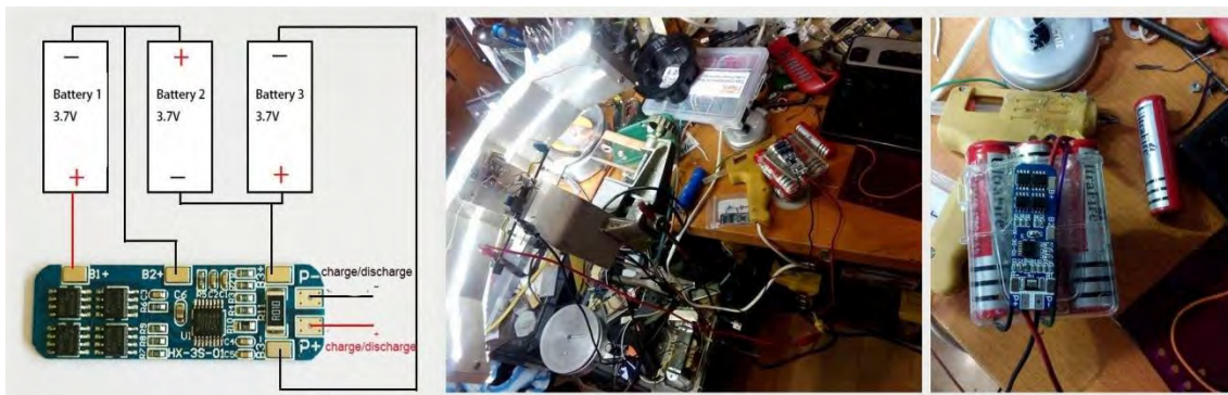
Figura 12. Aspecto final del banco de baterías.
