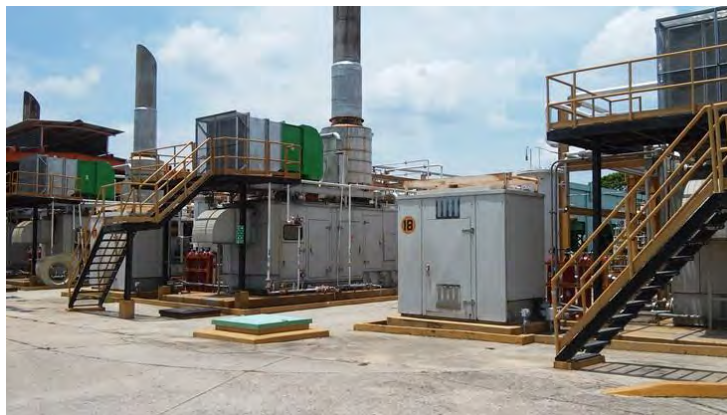
Figura 2. Estación de compresión caso de estudio
