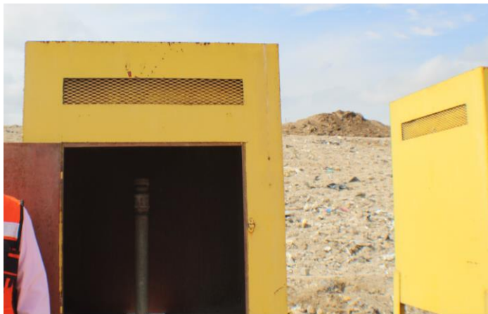
Imagen 7. Vista General de los Quemadores
