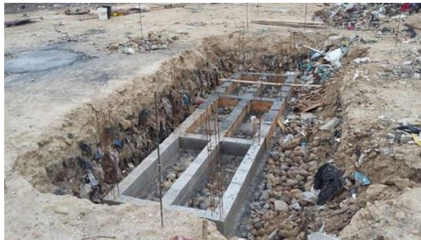
Imagen 6. Estructura general de preparación para el quemador
