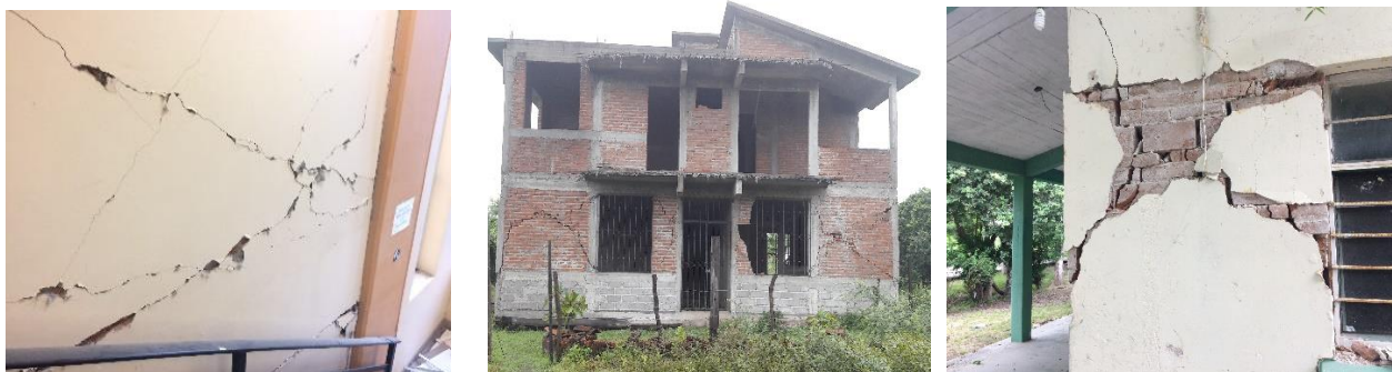
Figura 4- Falla por cortante en muro. Dos confinados y uno sin confinar.
