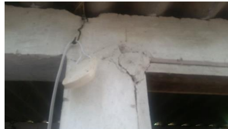
Figura 3- Agrietamiento en nudo trabe-columna
