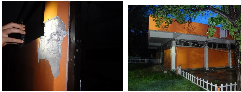
Figura 2- Condición de columna corta en Instituto Tecnológico
