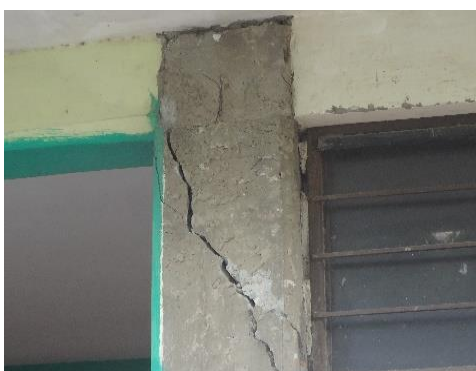
Figura 1- Cortante en columnas de concreto.
