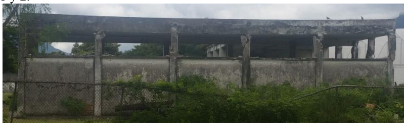
Figura 1- Falla por condición de columna corta en escuela agropecuaria
