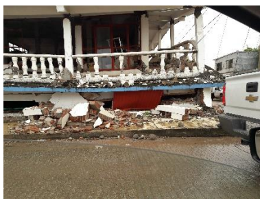
Figura 5- Escasez de elementos resistentes
