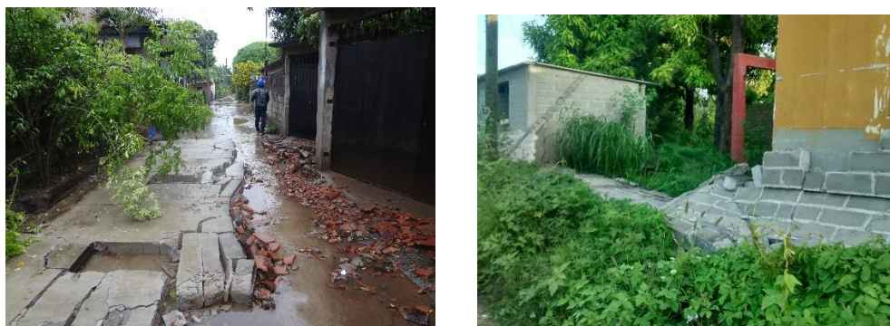
Figura 5- Falla en bardas perimetrales.
