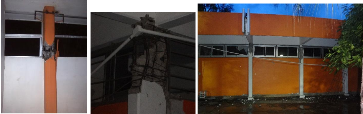
Figura 3- Falla por la condición de columna corta.
