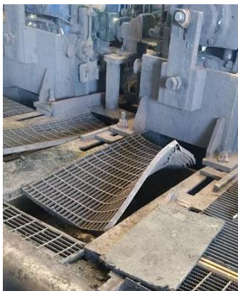
Figura 2.- Rejilla en mal estado
