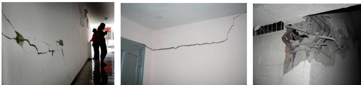
Imágenes 7 Fallas Estructurales
