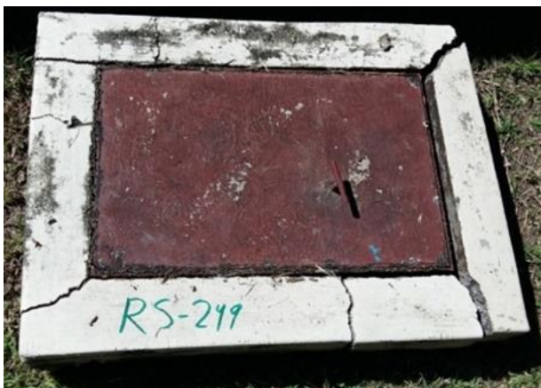
Imagen 1. Marco y tapa de registro sanitario en malas condiciones.
