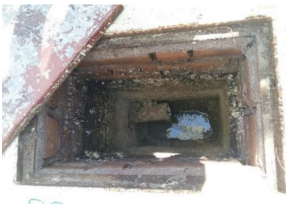
Imagen 3. Registro con material retenido provocando azolve.
