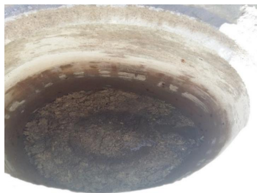
Imagen 4. Pozo de visita con gran cantidad de material que detiene el flujo del agua.
