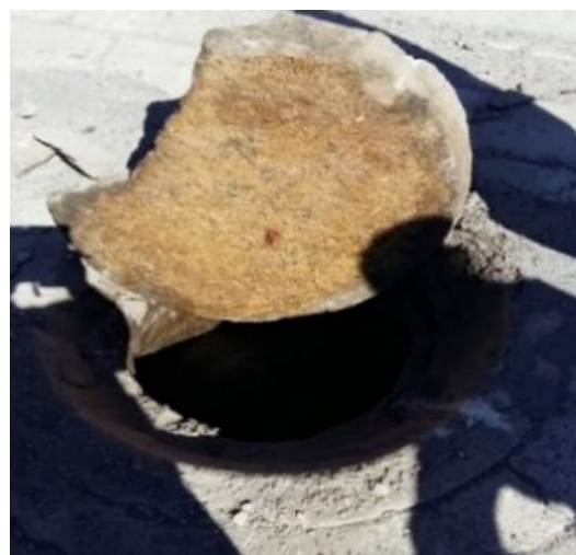
Imagen 2. Tapa de pozo de visita en mal estado.
