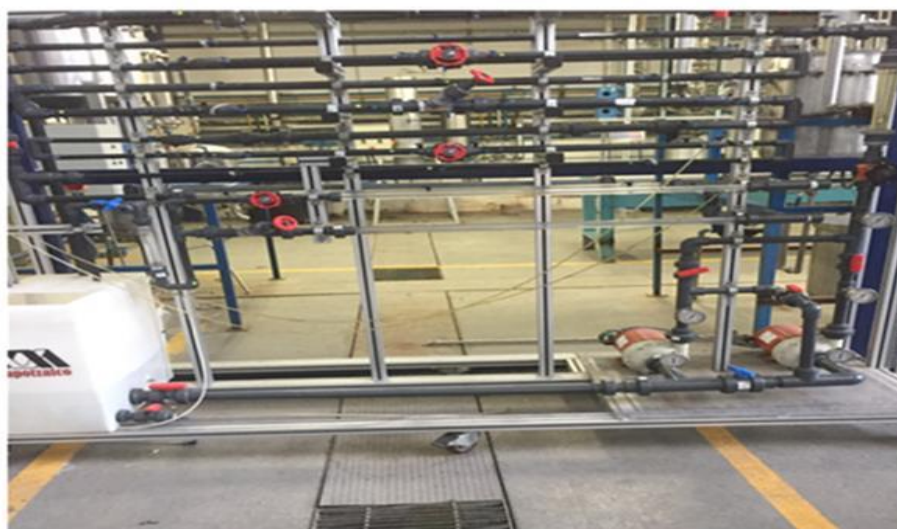
Fig. 2 Red de tuberías fabricada por una empresa francesa para la UAM-AZC.
