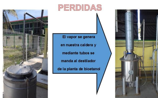
Figura 1.- Detalle de las pérdidas de calor de la calderilla.
