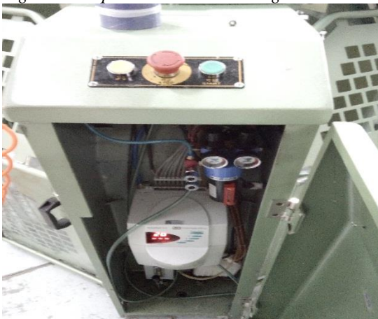
Figura 8 Variador de velocidad colocado
