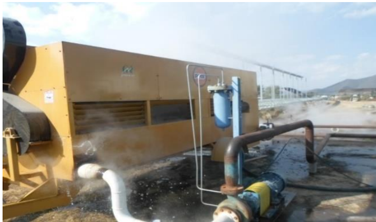
Figura 10. Sistema operando a un nivel estable de fluido geotérmico.
