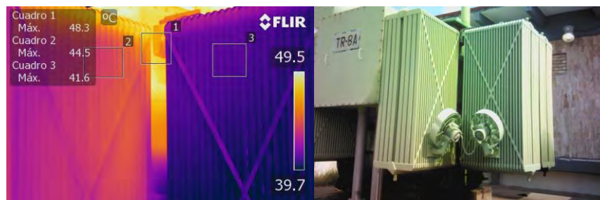
Figura 8. Transformador de potencia imagen térmica y digital
