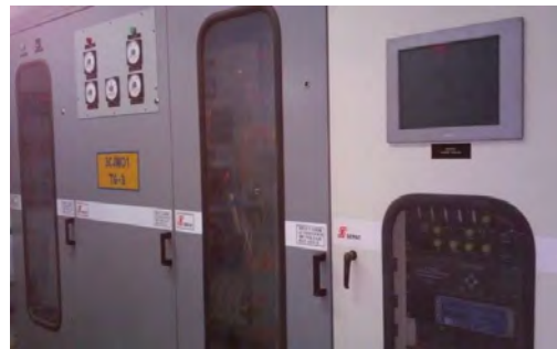
Figura 1. Regulador automático de voltaje.
