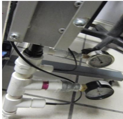
Figura10 Medidores de presión y temperatura de entrada y salida
